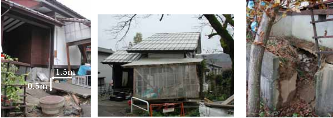
写真 8.7 斜面上部の住宅（A 邸）の被害状況
