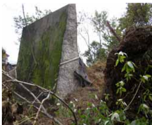
写真 8.26 高町団地の被害状況
