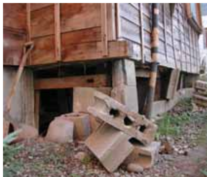
(b) 基礎被害 (外周 C B)
