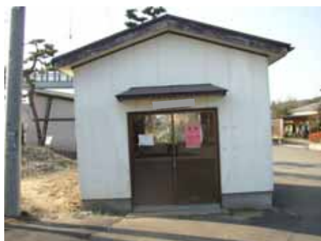
1/20 以上傾斜した建物
