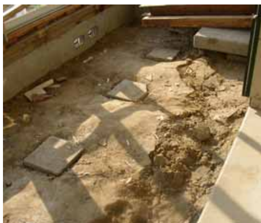
(c) 床下の地盤面の地割れ
