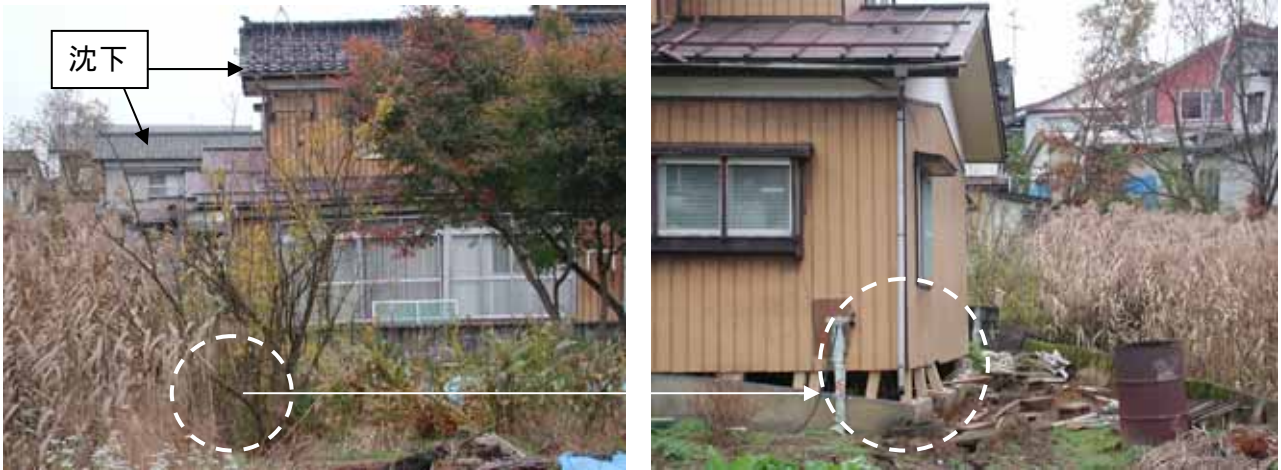
写真 8.9 周囲建築物（C邸）の沈下被害の例
