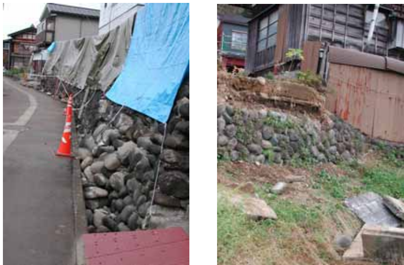
写真 8.22 増積み擁壁等の被害
