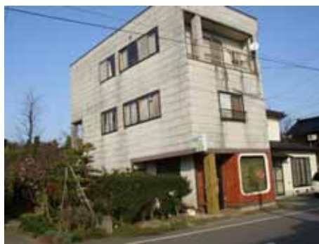
約 30cm 不同沈下が生じた建築物
