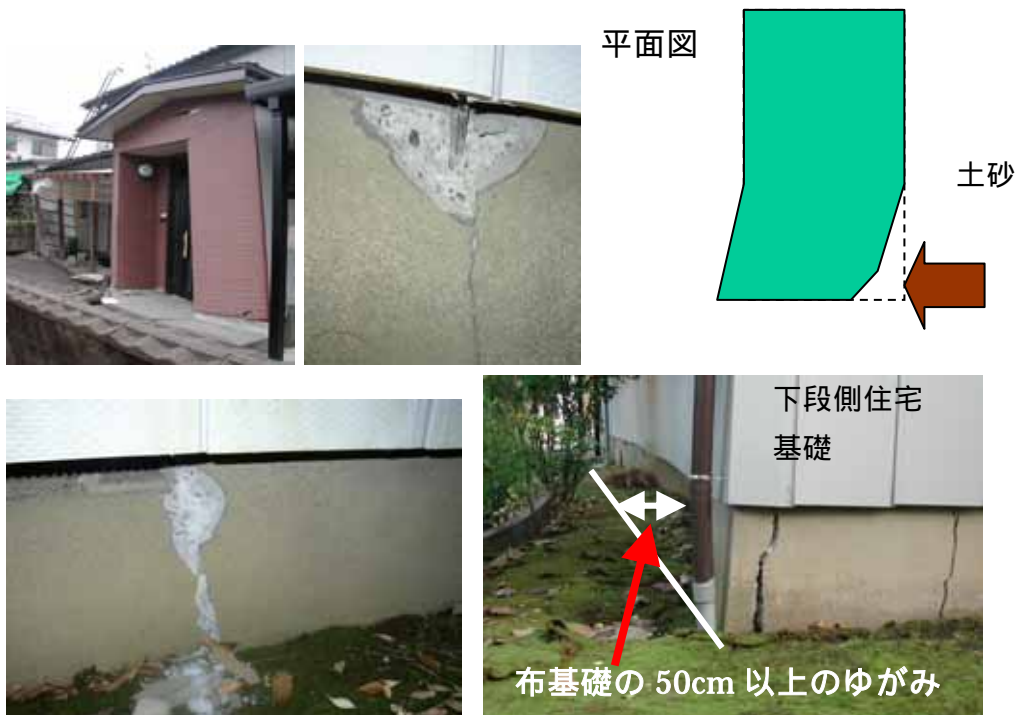
写真 8.8 斜面下部の住宅（B 邸）の被害状況 下段左：布基礎の圧壊
