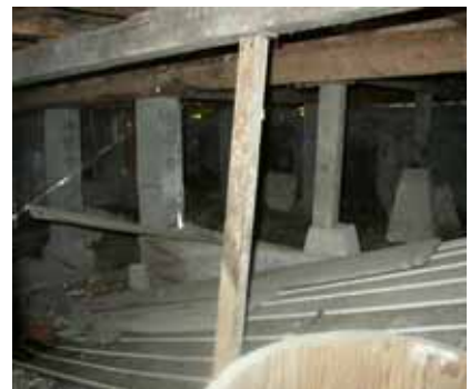
(c) 基礎被害 (内部)
