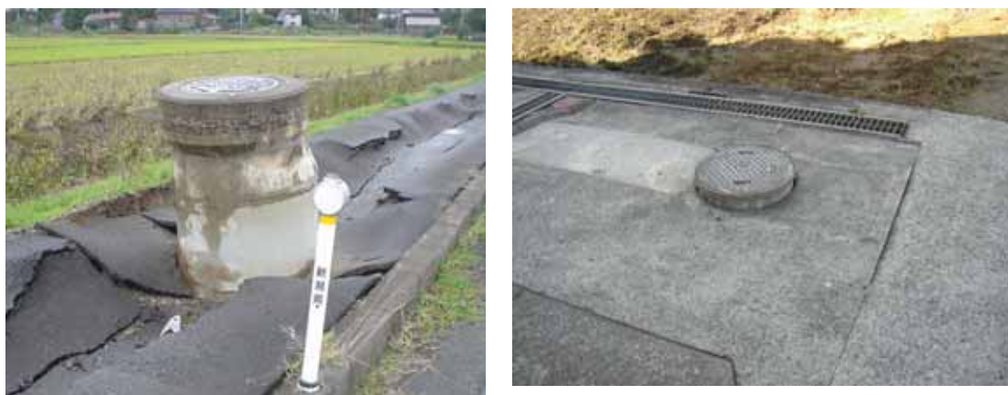
写真 8.6 液状化によるマンホールの浮き上がり
