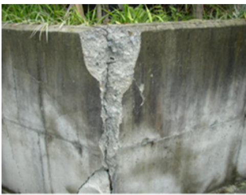
写真 8.31 宅地擁壁の被害
