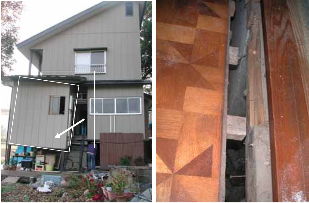
写真 8.19 被害住宅（外観）及び 1 階床面に生じたずれ（約 15cm）
