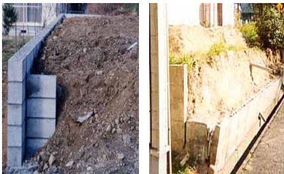
写真 8.43 ブロック塀の擁壁利用の例 左: 地中部の控え壁、右: 地震被害
