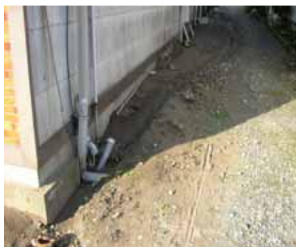
約 30cm 不同沈下が生じた建物周囲の噴砂
