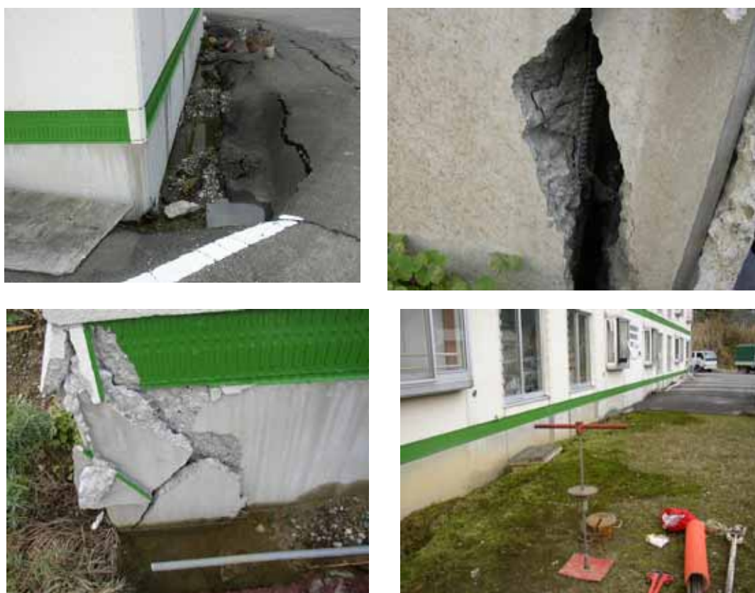
写真 8.39 一般建築物の鉄筋コンクリート造の基礎の被害（川口町）
