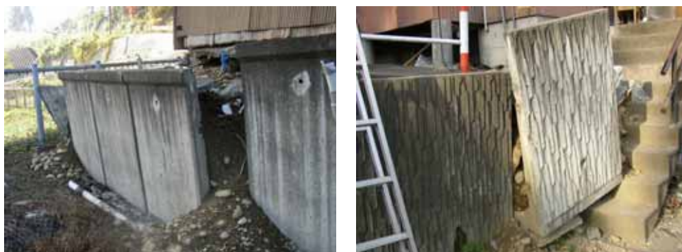
写真 8.17 プレキャスト擁壁の移動とそれに伴う被害
