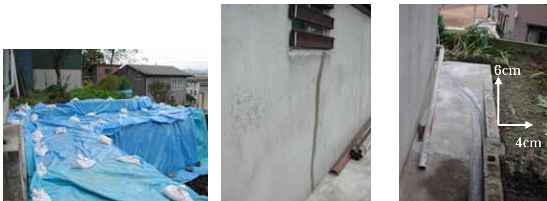
(a) 擁壁被害
