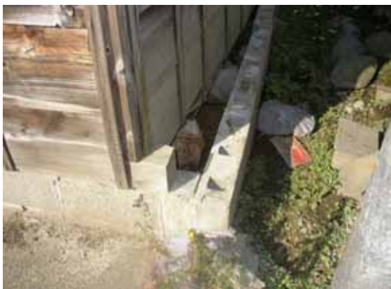
(a) 基礎と上部構造とのずれ
