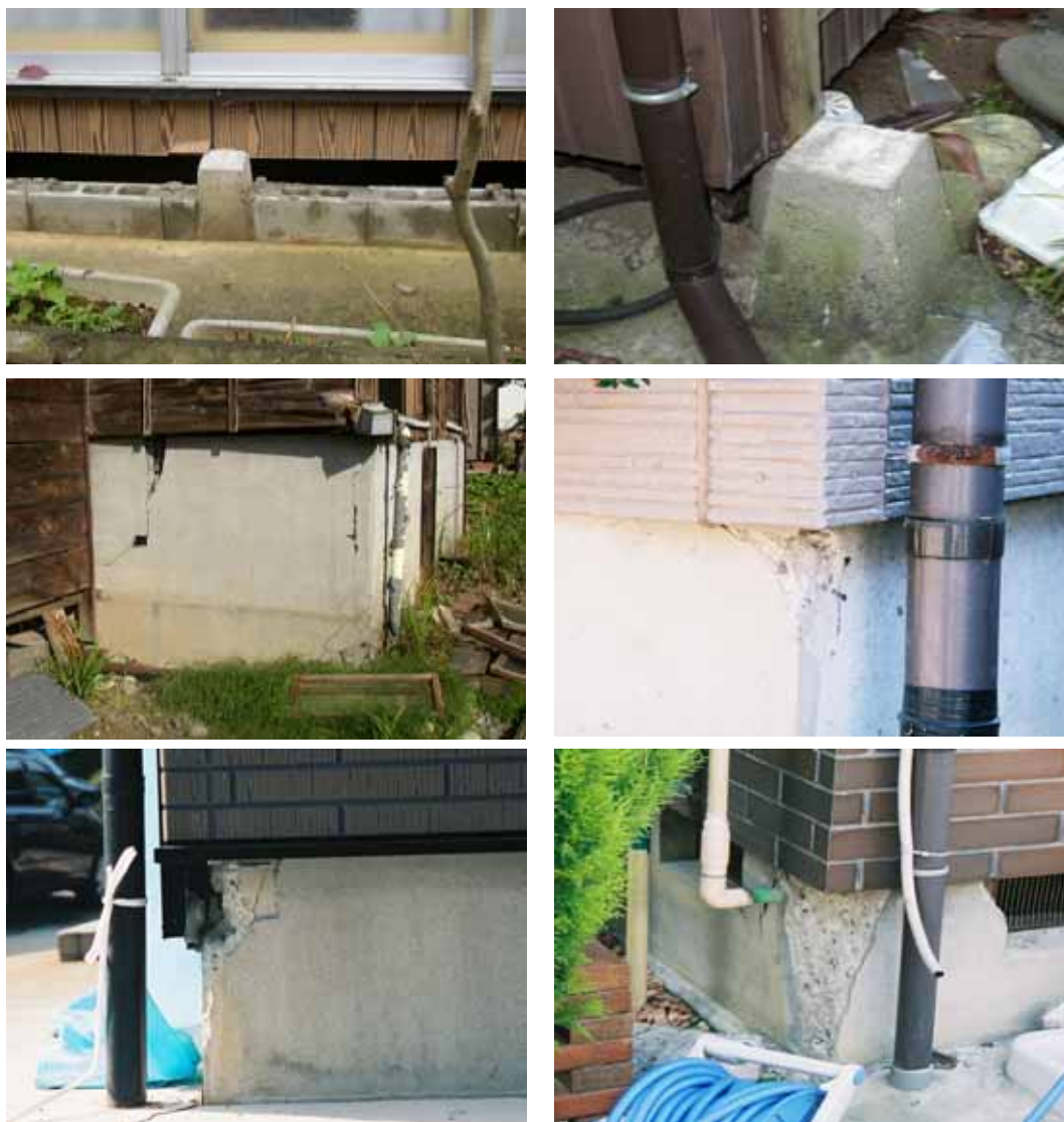
写真 8.4 戸建住宅の基礎の被害状況
