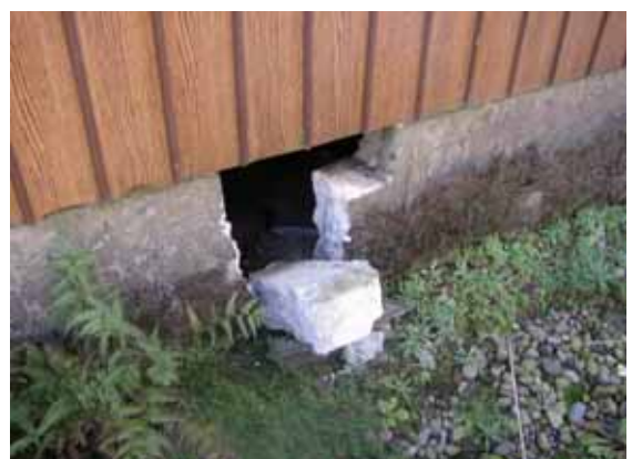
(b) 無筋コンクリート基礎の破損
