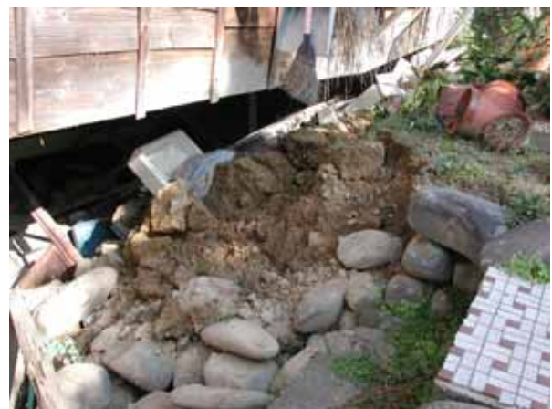
(b) 基礎被害
