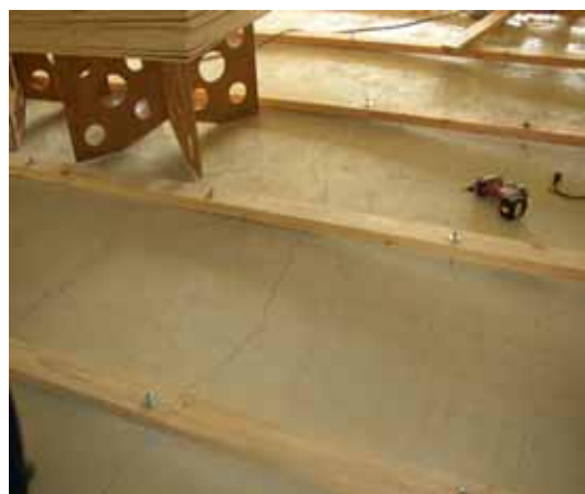
(d) 1階床面の隆起状況
