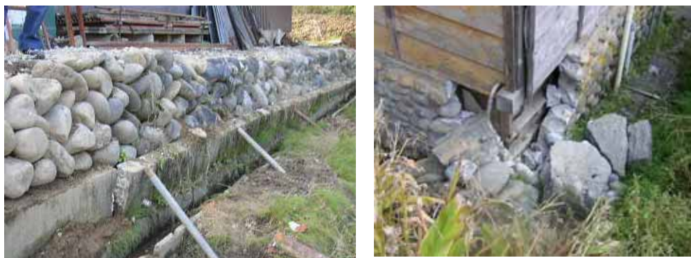
写真 8.18 石積み擁壁・土留めや基礎の被害
