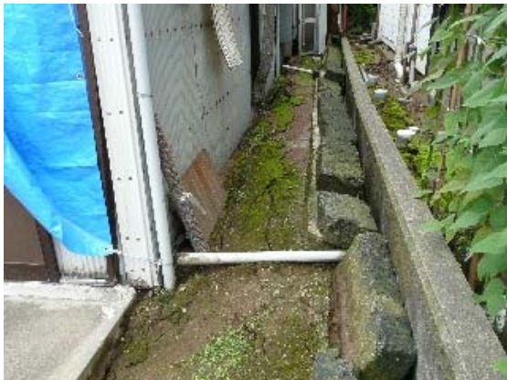
低い擁壁の被害
