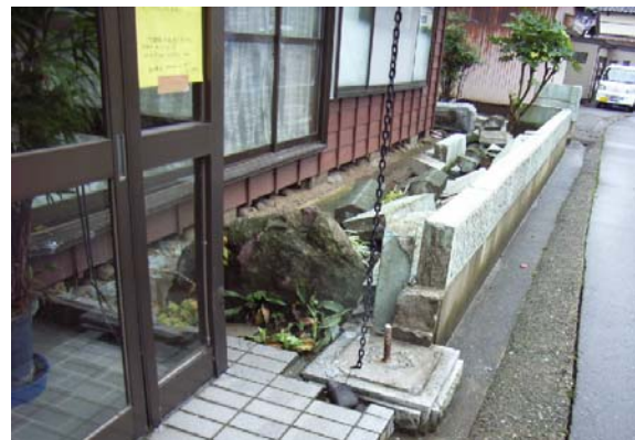
門柱の鉄筋と石塀の倒壊
