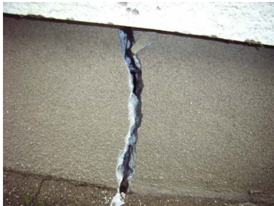
基礎のひび割れ
