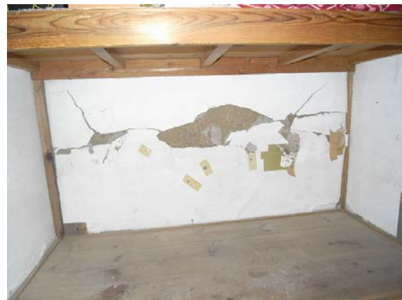
内壁のひび割れ
