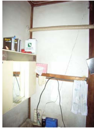
内壁のひび割れ
