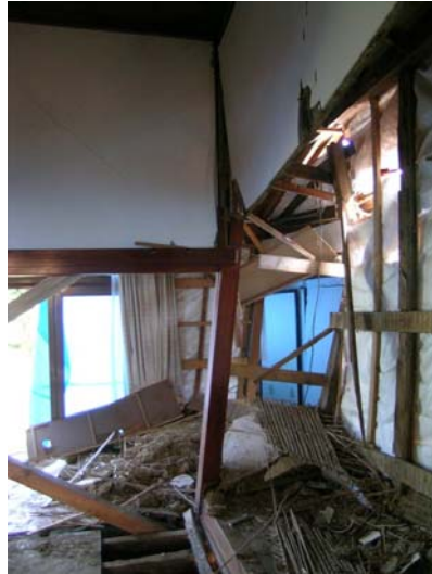
柱折損の詳細
