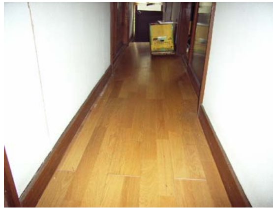
床の傾斜と内壁のひび割れ
