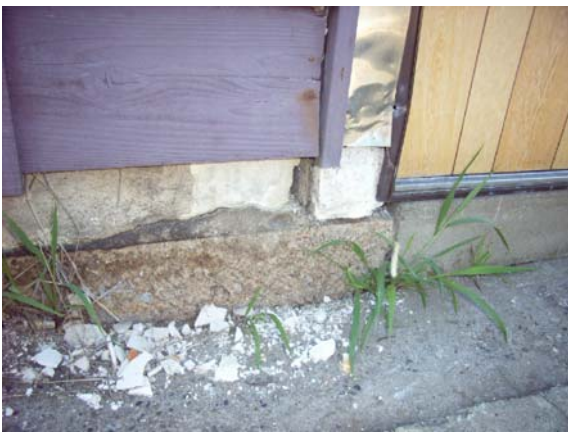
道路側の切石基礎の割れ
