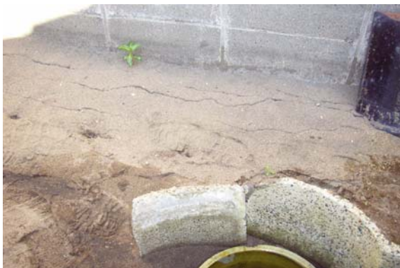
庭の砂のひび割れ
