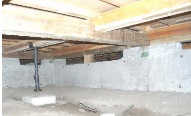
床下（束が浮き上がっている）
