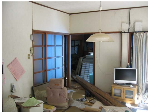
食堂のせっこうボードの亀裂・剥落
