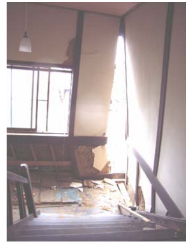
通し柱から抜けた梁
