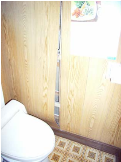
内壁面材の座屈
