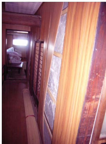
内装合板の座屈
