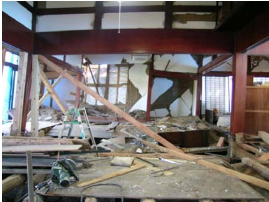
内部 柱の折損、壁の剥落がある
