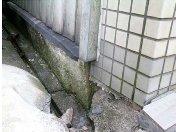
切石基礎の転倒・移動
