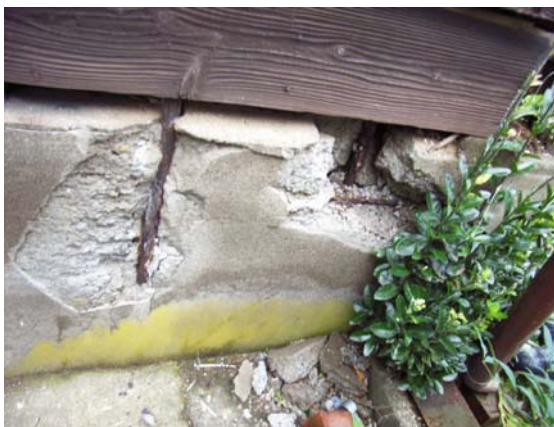
基礎のひび割れ
