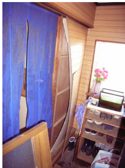
内装合板の座屈
