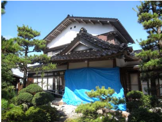
全景（玄関部分に大きな被害）
