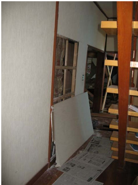
増築部分の廊下のせっこうボード剥落
