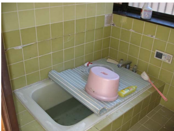
浴室タイル目地亀裂・剥落
