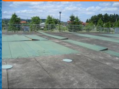
覆蓋浮き上がり
