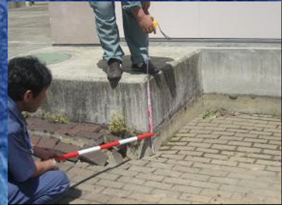
場内地盤沈下
