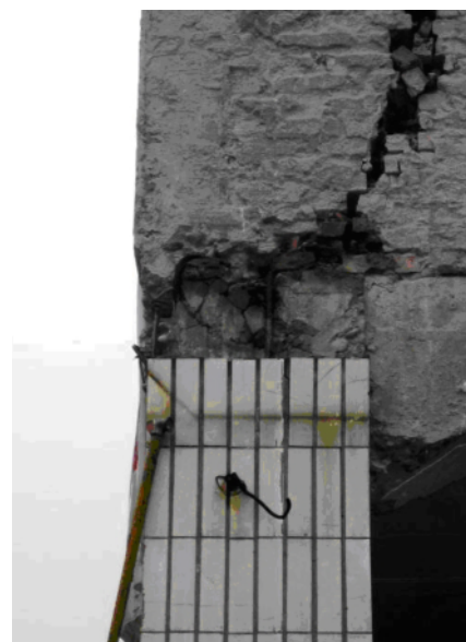
写真 5.5 2階に被害が集中した建物(都江堰) 写真 5.6 写真 5.5 の1階柱と2階柱の接合部
