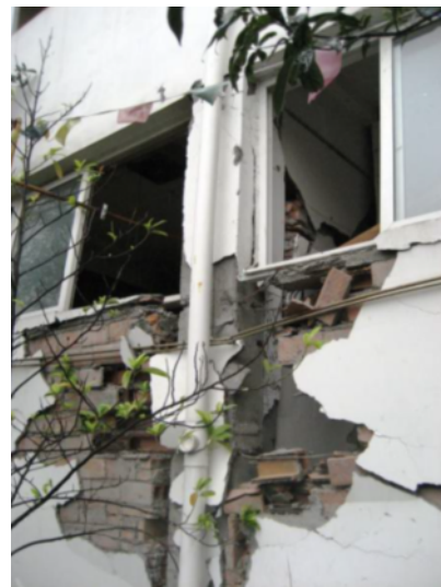
写真 5.9 腰壁が先に壊れて短柱とはなら
