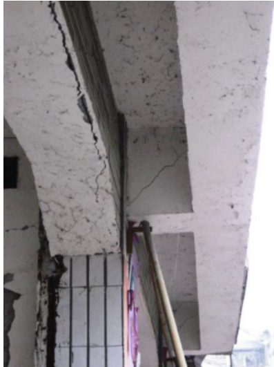
写真 5.7 1階柱と2階柱をつなぐ梁のせん断破壊（都江堰）
