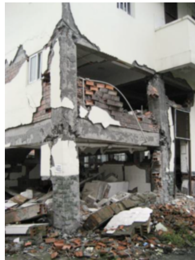
写真 5.11 柱頭・柱脚の曲げ破壊（映秀）
