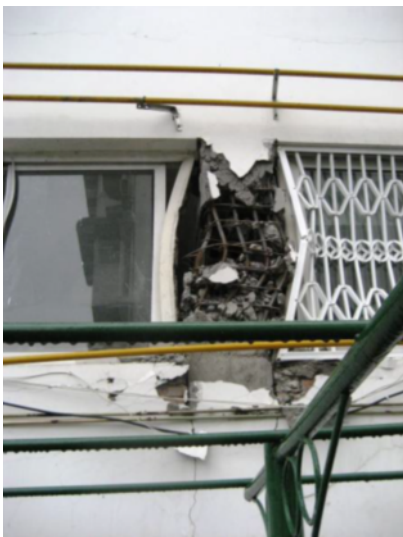
写真 5.8 短柱のせん断破壊（都江堰）
