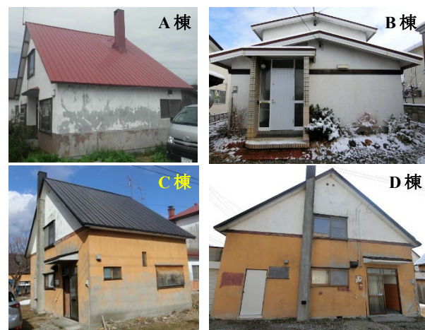
写真1 北海道旭川市の調査対象住宅4棟の外観と劣化状況の差異について考察した。調査対象住宅4棟の現況の変状や生物劣化の発生率、現況と躯体の関係性
