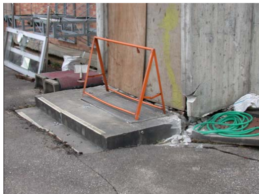
写真-6.15 建物周辺部の液状化被害
