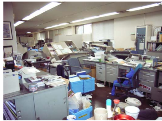
写真-6.4 室内のオフィス家具の転倒被害
