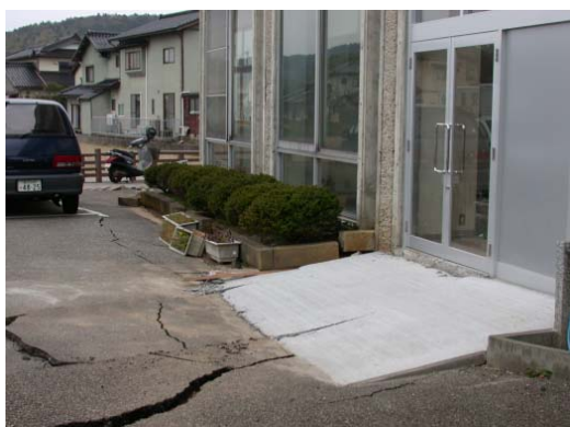
写真-6.16 建物周辺部の液状化被害
