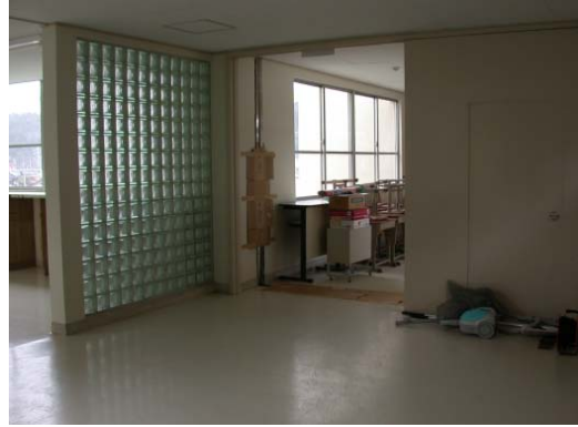
写真-6.8 校舎棟 EXP. J 部の被害
