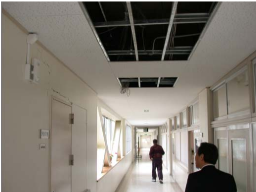
写真-6.9 校舎棟の廊下天井パネルの落下被害
