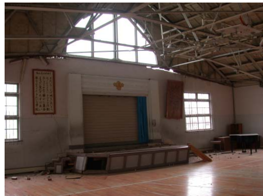
写真-6.12 講堂の妻壁部の被害
