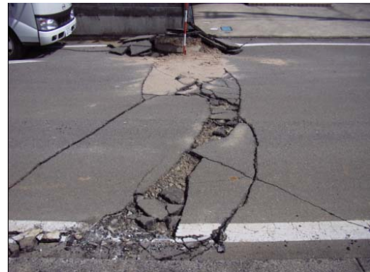
写真-6.6 総合福祉会館周辺の地盤変状
