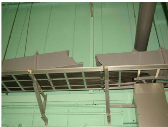
写真-4.7 脱臭ダクトの破損 （門前水質管理センター）
