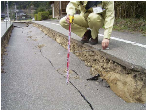
写真-4.5 埋戻し部の陥没（約 35cm） （輪島市門前町田村地区）
