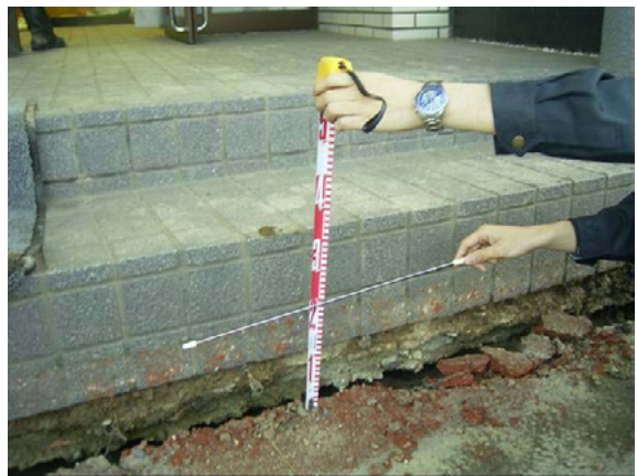
写真-4.8 建物と地盤のズレ （門前水質管理センター）
