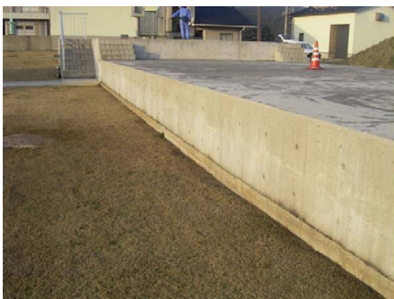
写真-4.9 OD 槽周辺地盤沈下（10cm 程度） （門前水質管理センター）
