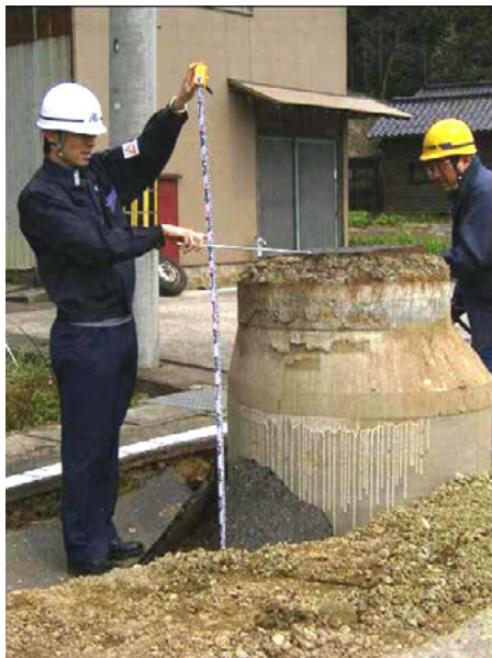
写真-4.3 マンホールの浮き上がり（約 1m） （輪島市門前町田村地区）
