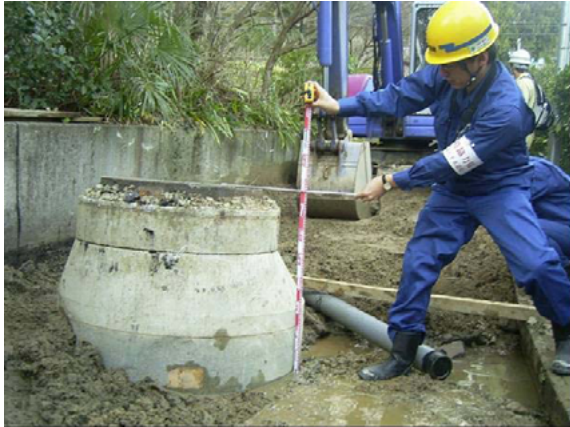
写真-4.1 マンホール浮き上り（舗装撤去面から約 70cm、輪島市門前町和田地区）
