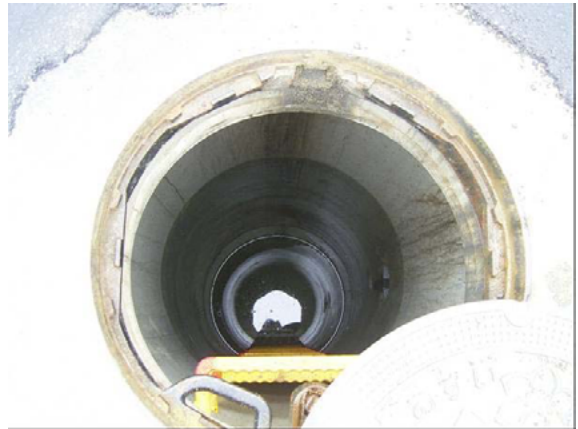
写真-4.6 マンホール内湛水 （輪島市門前町門前幹線）
