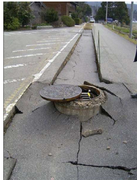
写真-4.4 埋戻し部の陥没 （輪島市門前町田村地区）
