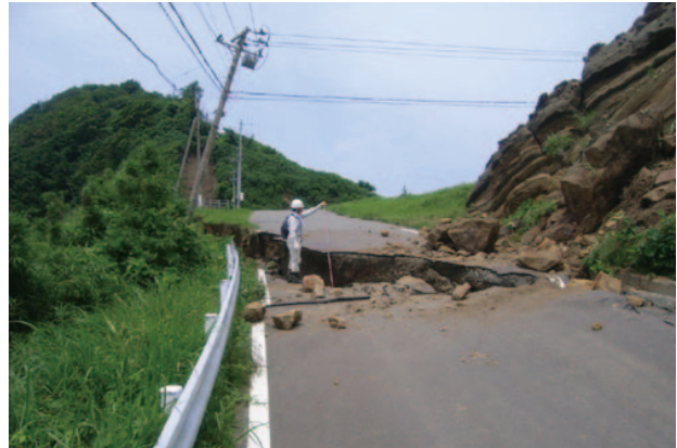
写真-3.14 市道に生じた段差(7月19日撮影)
