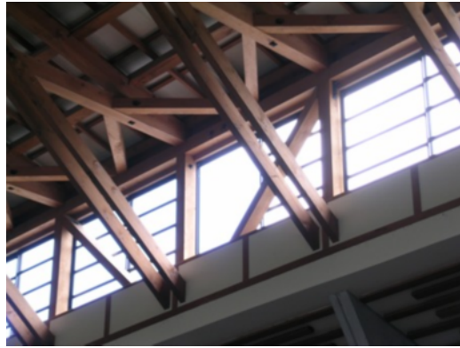
(b) 高窓サッシ脱落部の内部小屋組
