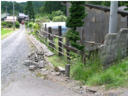
(a) ブロック塀の倒壊
