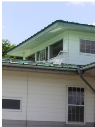
図-2.3.4 B小学校に隣接する木造建物の2階サッシの落下
