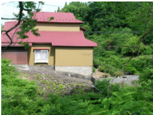
(a) 擁壁の亀裂があった住宅
