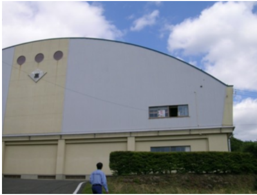
(a) 体育館妻面の窓ガラス破損
