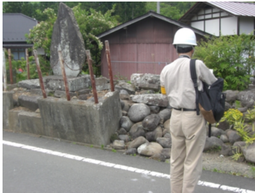
(a) 石碑基部の崩壊
