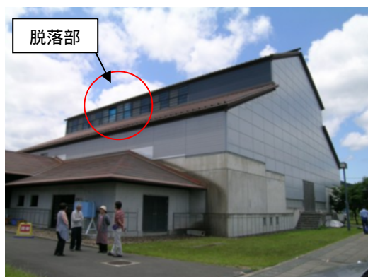
(a) D建築物外観及び南側脱落部
