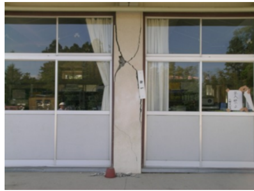
(b) 1階柱のせん断破壊
