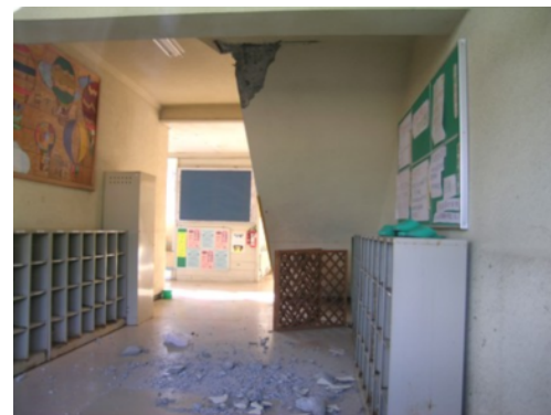
(d) 1階階段上部の損傷
