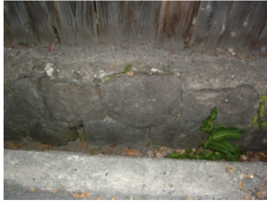
(b) 擁壁モルタルはがれ
