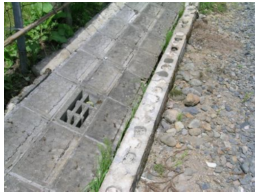
(b) 同詳細 鉄筋は見当たらない
