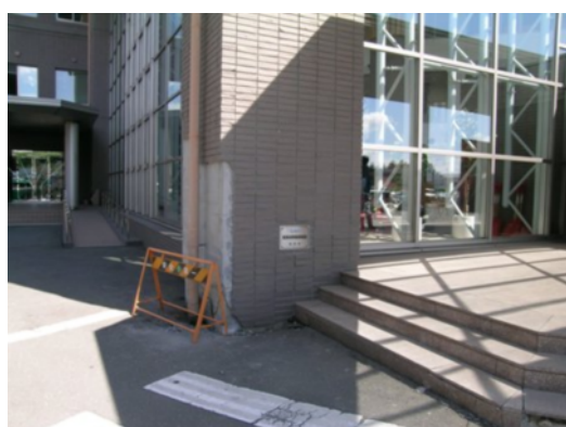
(c) 外装タイルの剥落
