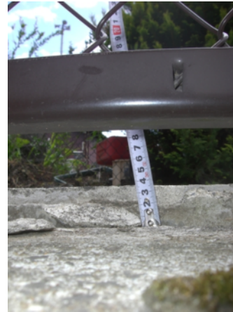
(b) 水路際の地盤の沈下
