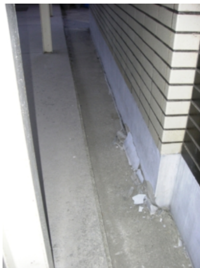
(a) 新校舎東側妻壁脚部の破損
