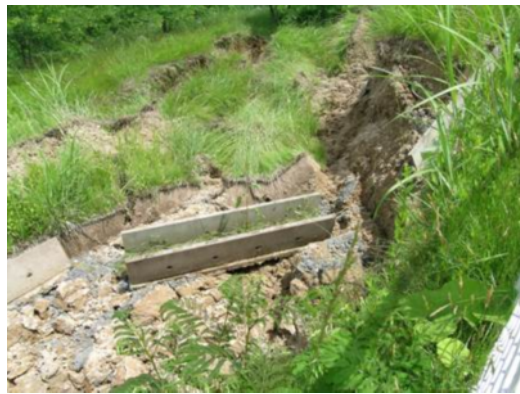
図-2.3.3 B小学校校庭南側の法面崩壊
