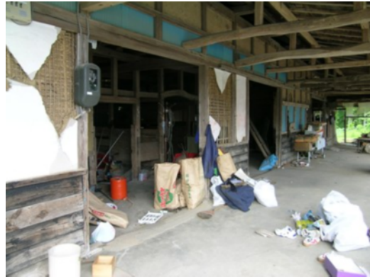
(b) 同住宅牛小屋の土壁剥落
