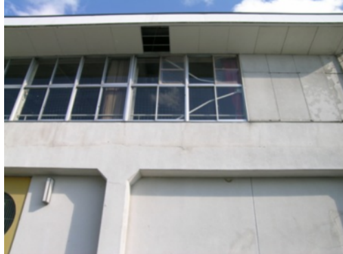
(b) 軒天落下及びブレース座屈
