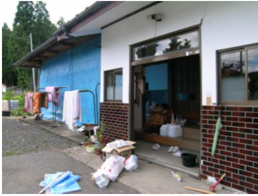
(a) 外壁損傷及びサッシの脱落
