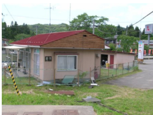
図-2.3.11 栗駒松倉地区の住家被害（妻壁仕上げ剥落）
