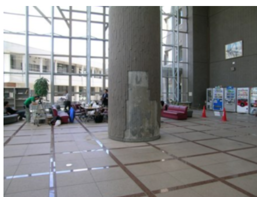
(d) 内部柱の仕上げタイル剥落
