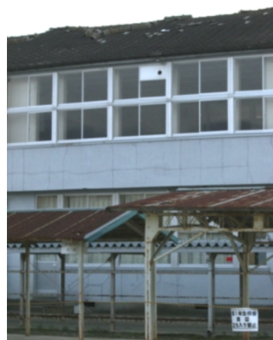
(b) 旧校舎の棟瓦落下
