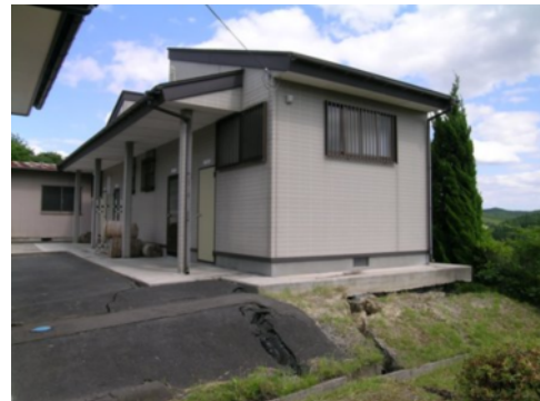
(b) 南側斜面擁壁上部の建物（基礎下に地割れ）
