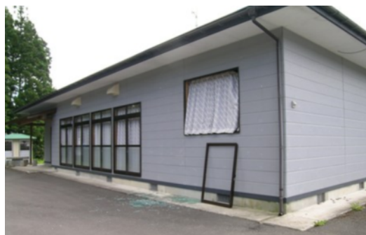
(a) 建築物F（窓サッシ脱落）
