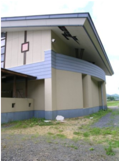
(a) 軒天外装材落下
