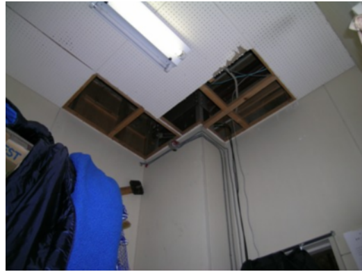
(b) ステージ脇2階天井板の落下
