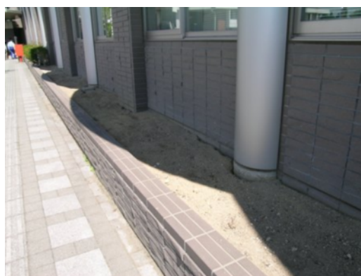
(b) 建築物脚部の地盤との隙間
