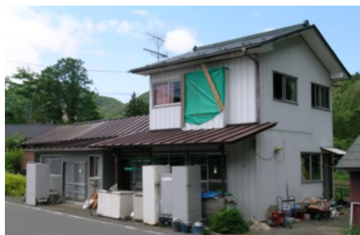
(b) 住宅の窓の損傷
