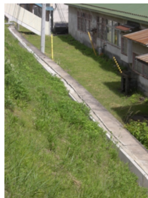
(c) 北側最上段の擁壁頂部のはらみ出し
