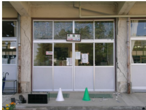
(c) 1階出入口脇の柱の損傷
