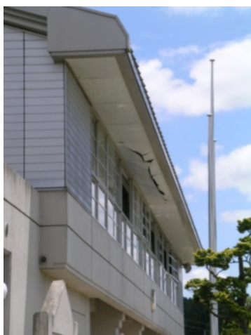
(a) 南側被害状況
