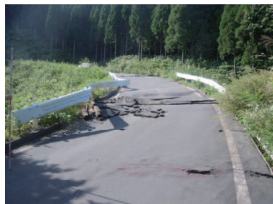
写真-2.2.2 地点bに生じた変状
