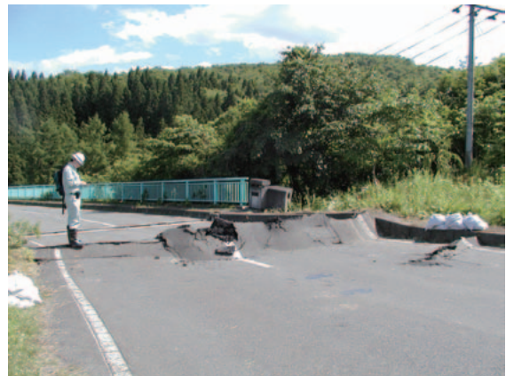
写真-2.2.9 地点jの県道49号線餅転橋アバウト部（奥州市側）の路面座屈
