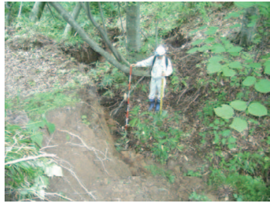
写真-2.2.25 地点 e に生じた変状
