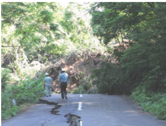
(a) 道路を閉塞した崩壊土砂
