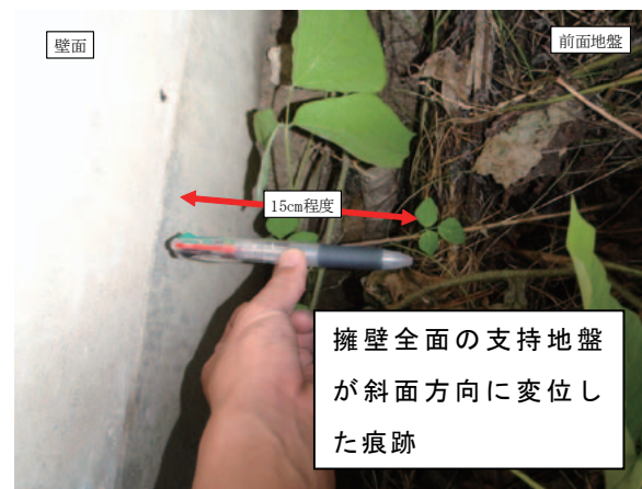
図-7.5.2 馬留大橋 支持地盤と壁面との間の相対変位
