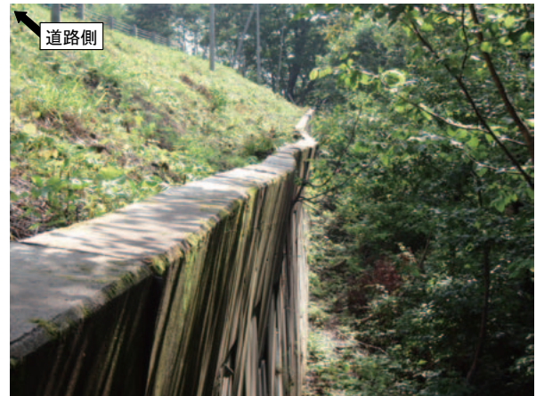
図-7.5.7 国道 342 号線 成瀬村付近におけるテールアルメ壁の被害（壁面の傾斜）
