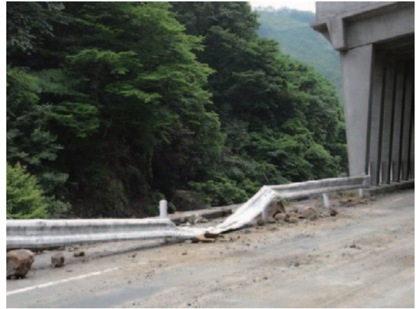
(f) ガードレールの損傷
