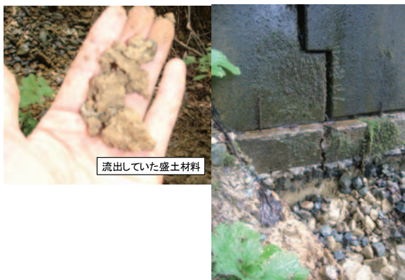
図-7.5.8 はらみ出した難透水性の盛土材と背面の排水材
