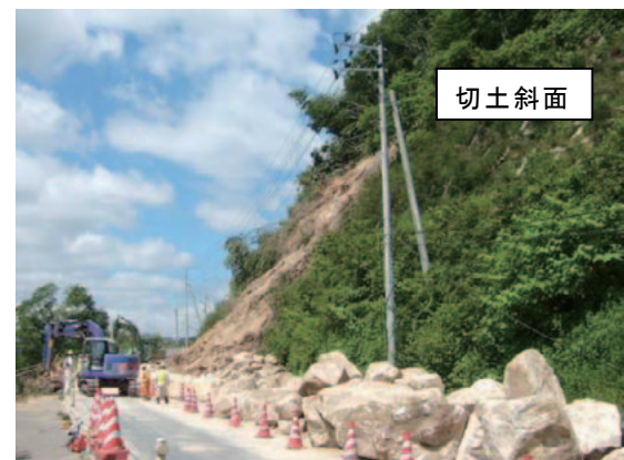
図-7.4.2 軽量盛土箇所、切土斜面の崩壊
