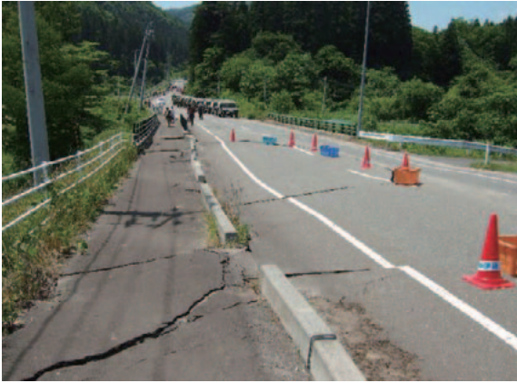
図-7.4.6 花山地区岩ノ目沢橋取り付け盛土の被害
