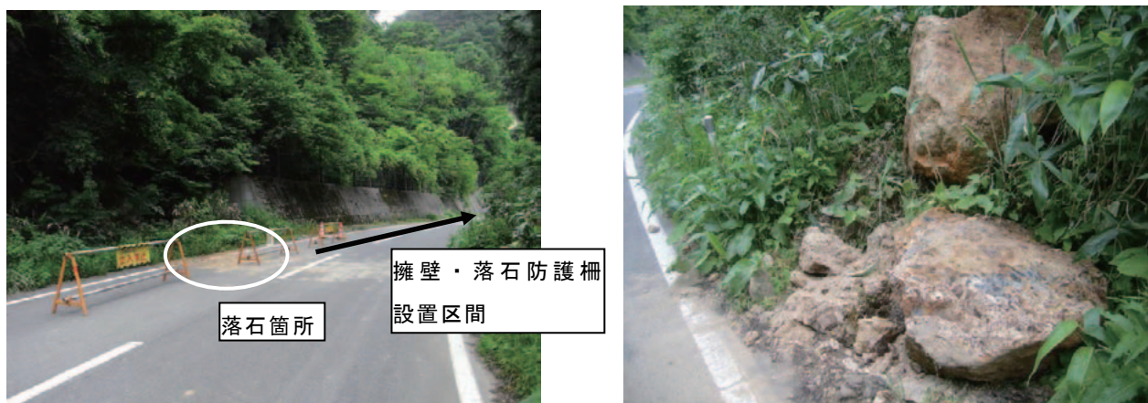
(a) 落石現場
