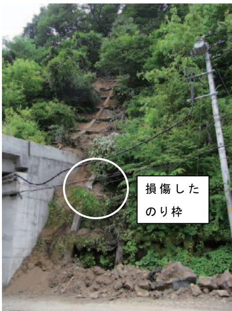
(c) 落石を伴う土砂崩壊が発生した斜面
