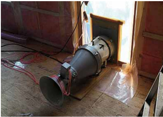
写真1 気密性能試験の様子
