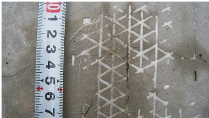
d. 繊維ネットの露出箇所の拡大 ネットの繊維が一部切れている様子が観察されるが、完全に破断しているものは見られない。
