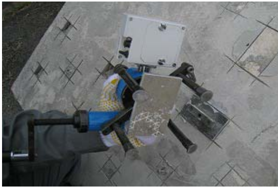
a.破断箇所
