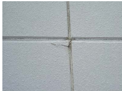
⑦シーリング接合部周辺の ALC のひび割れ（高接着力による部材破壊）
