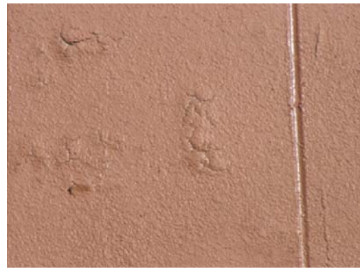
②塗装材のふくれ（漏水による劣化）
