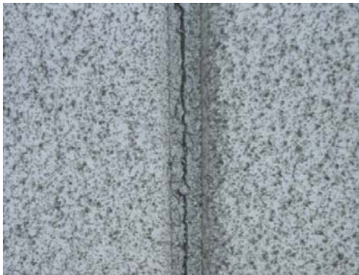
⑤シーリング接合部のひび割れ
