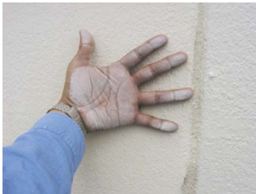
①塗装材の劣化（チョーキング）
