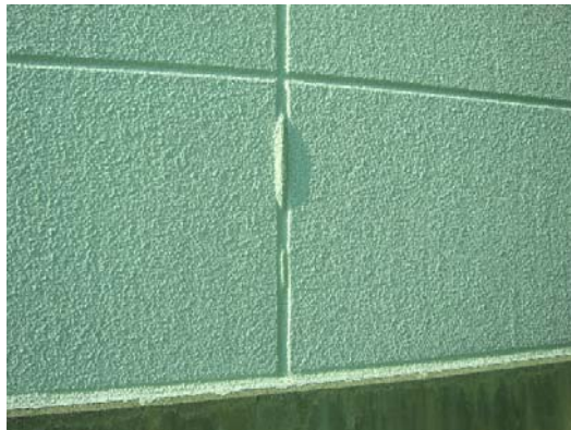
⑥シーリング接合部の塗装材のふくれ
