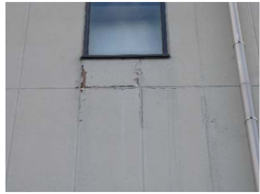
④塗装材のはく離（開口部からの漏水による劣化）
