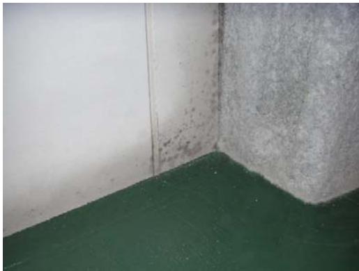
③カビの発生（漏水による劣化）
