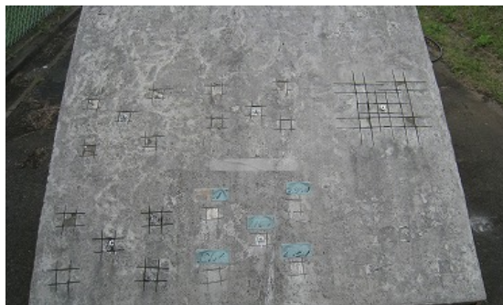
a. 地面から 45 度の傾斜で暴露した試験体の表面。汚れがひどく表面観察しにくい状態であった。
