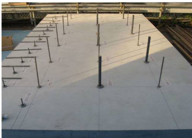
付写真1.1.1 コンクリート版及びアンカー筋打設状況の一例
