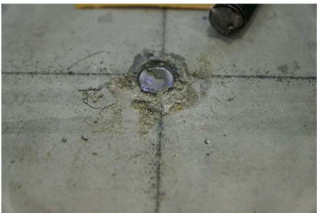
(M20-B15) *アンカー筋の破断
