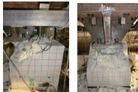
図 2 側方破壊した接合部
