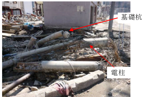
写真3 基礎杭の状況(原位置) 既成PC杭(径300mm、PC鋼線6-φ7)
