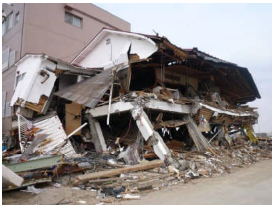
写真1 倒壊した混合構造建物
