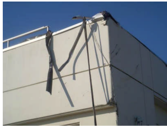
写真2 2階手摺の破損
