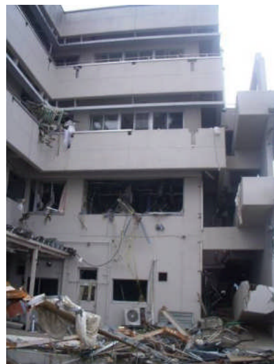
写真4 窓ガラスの破損状況
