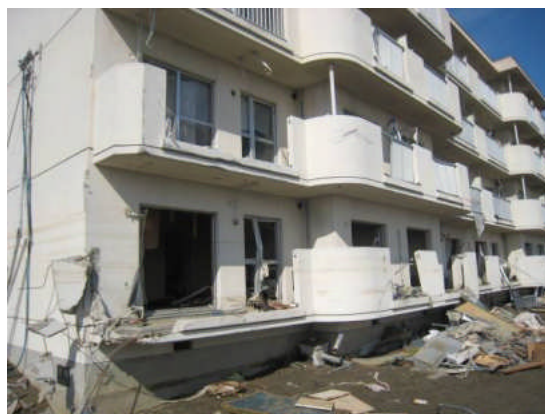
写真3 窓ガラスの破損
