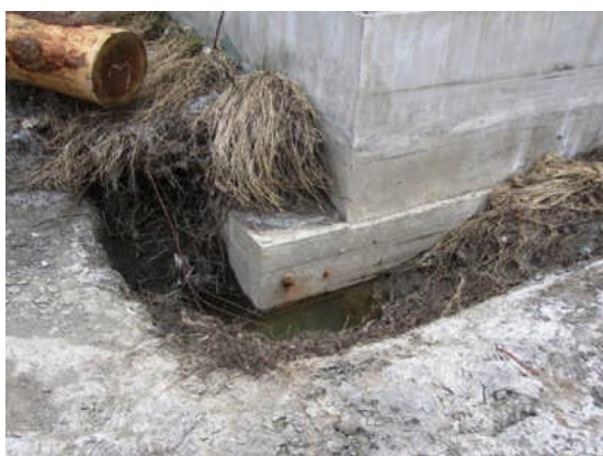
写真3 洗掘した基礎
