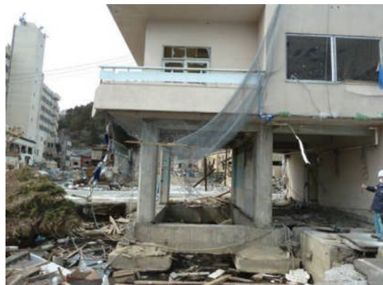
写真4 洗掘された基礎
