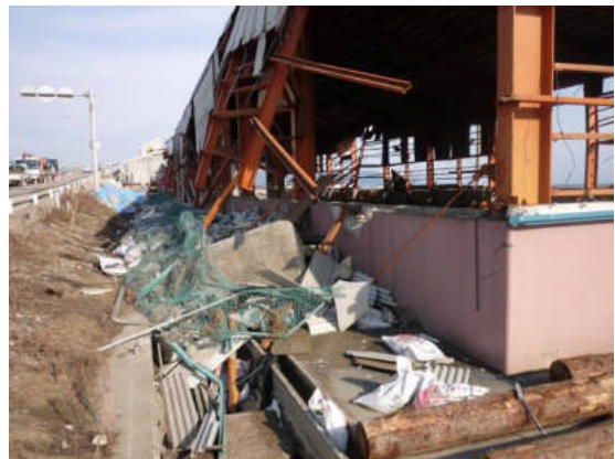
写真4 損傷状況（倉庫2、道路側）
