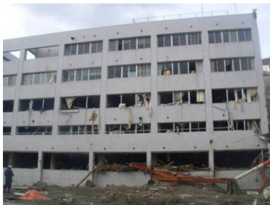
写真3 新館開口部の被害状況 (4階までの窓ガラスに破損が認められる)
