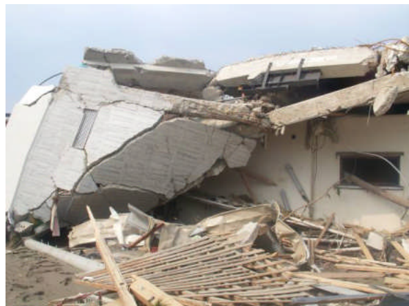
写真3 耐力壁の倒壊
