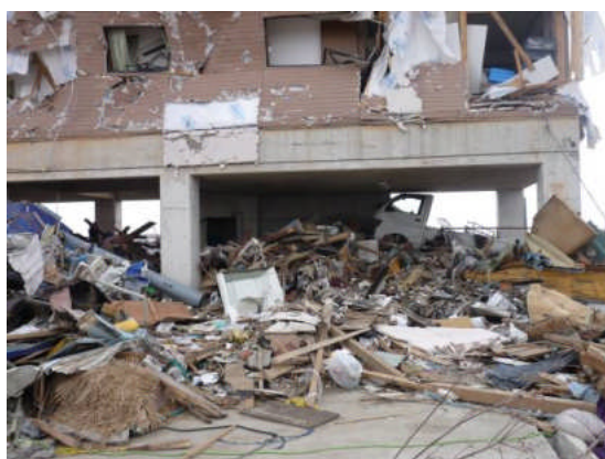
写真4 1階RC造架構は無被害
