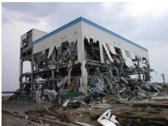
写真3 2階天井より下の外装材が流失
