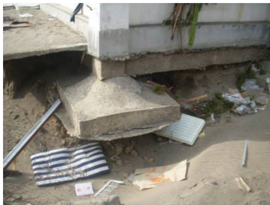
写真3 周辺地盤の洗掘
