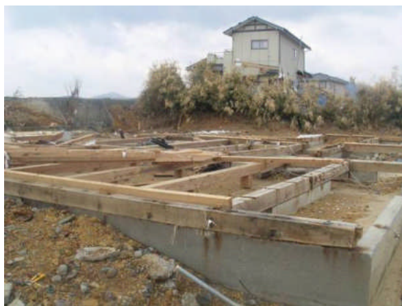
写真2 写真1の住宅と上部構造が流失した住宅
