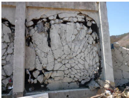
写真3 RC造壁の面外破壊
