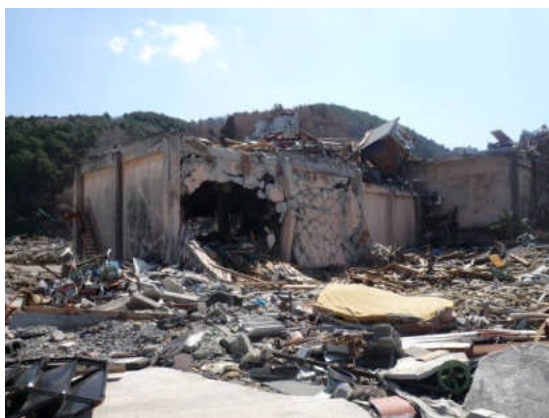
写真1 壁の面外破壊 (建物西面)
