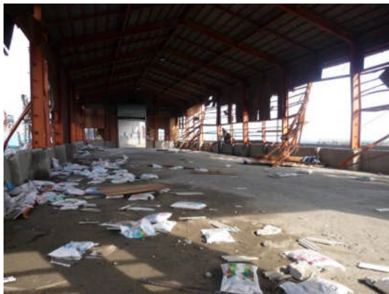
写真3 胴縁の損傷（倉庫2）
