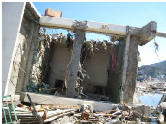
写真3 建物正面 (有開口外壁の破壊)
