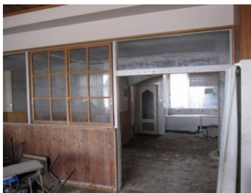
写真2 室内の浸水痕
