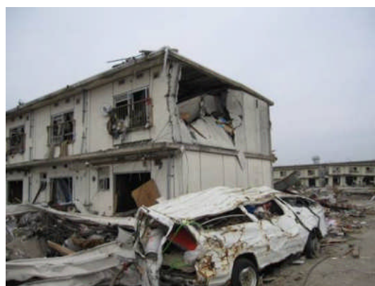
写真2 2階妻壁の損傷
