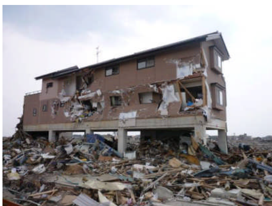
写真3 漂流物の衝突による被害
