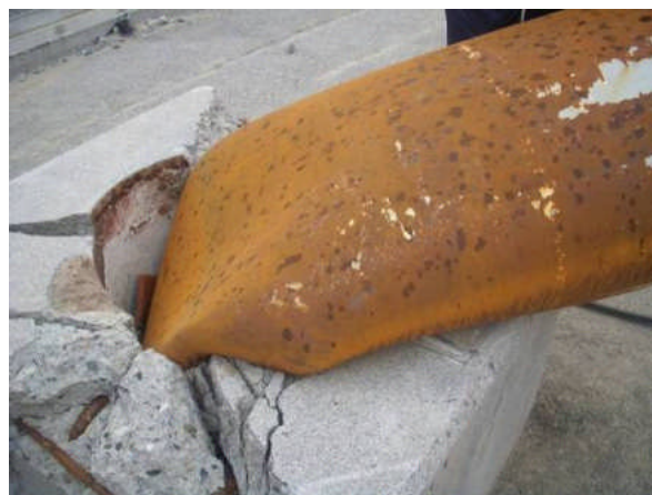
写真2 柱脚部のコンクリートの状況
