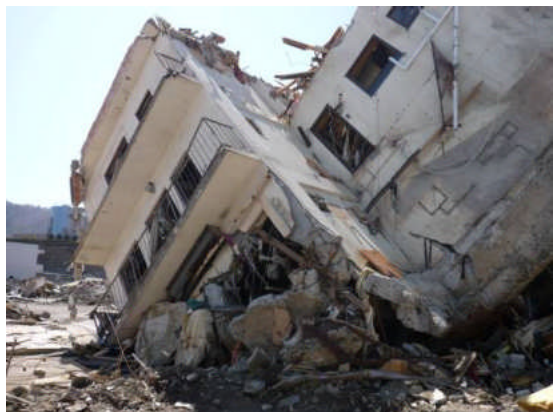
写真4 隣で転倒した建物
