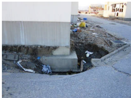
写真4 洗掘した杭基礎(2)
