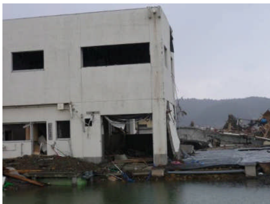
写真3 外壁の面外方向の変形
