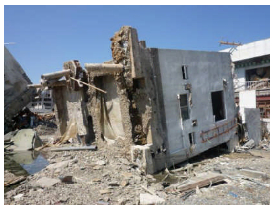
写真2 建物底面 (杭の破損)
