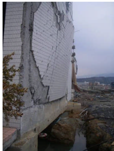
写真2 外壁の面外変形
