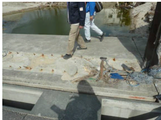
写真2 破断した壁筋
