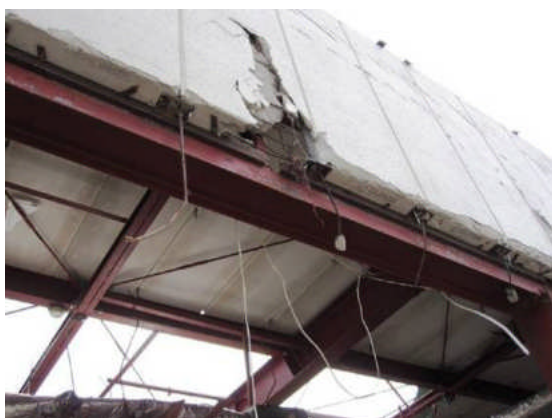
写真3 損傷したALCパネル
