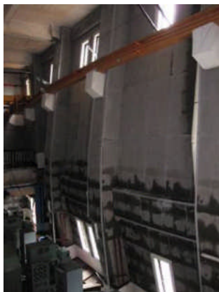
写真 3 耐力壁の面外変形
