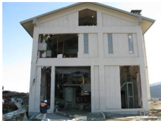
写真 2 脱落した ALC パネル
