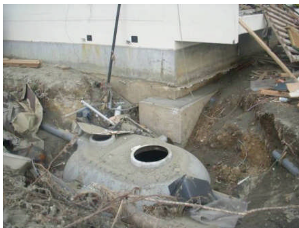
写真4 地盤の洗掘状況
