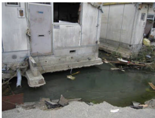
写真3 周辺地盤の洗掘
