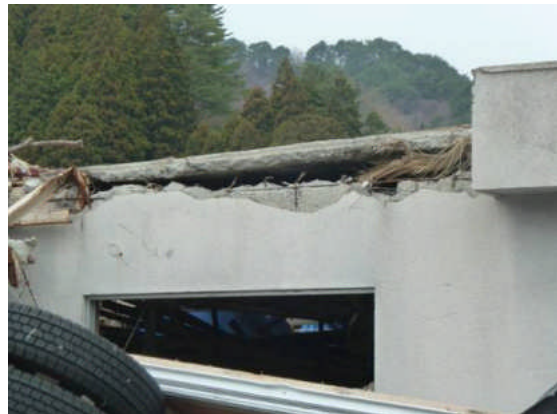
写真2 損傷した屋根部分
