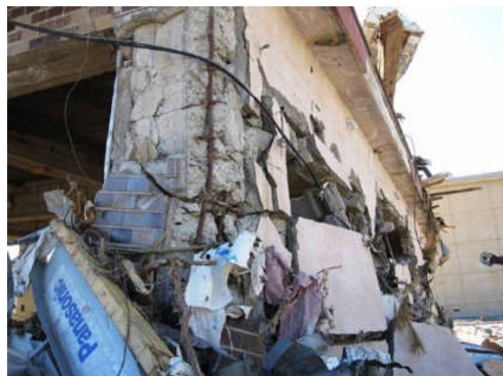
写真4 損傷したコンクリートブロック壁
