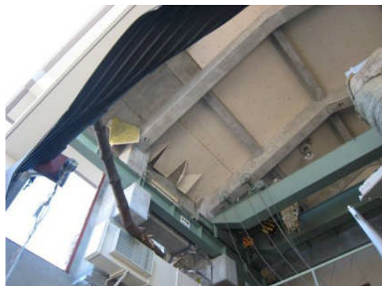
写真 4 天井材の剥落
