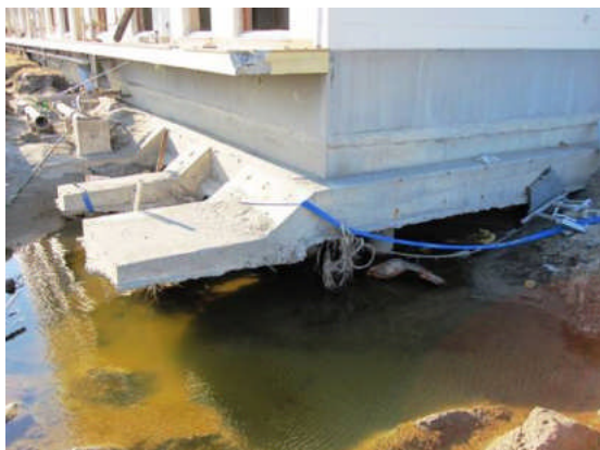
写真3 洗掘した杭基礎(1)
