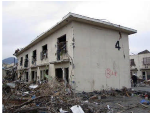
写真2 残存した住棟
