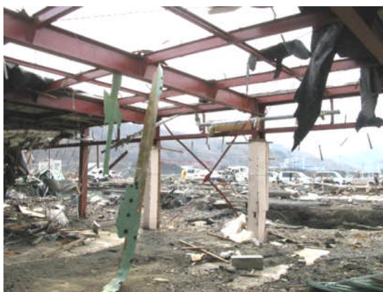
写真3 ブレースの破断と屋根版の流失
