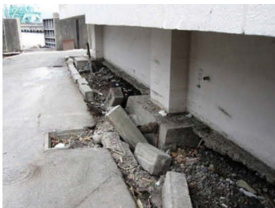
写真3 洗掘された基礎
