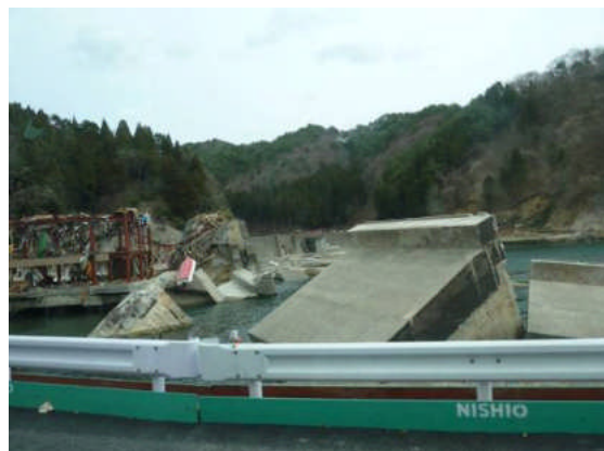
写真4 近傍で決壊した堤防
