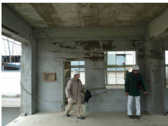
写真3 建物1階の浸水痕
