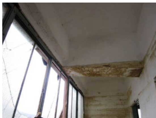
写真4 建物1階の浸水痕
