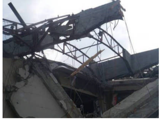
写真6 屋根の倒壊状況
