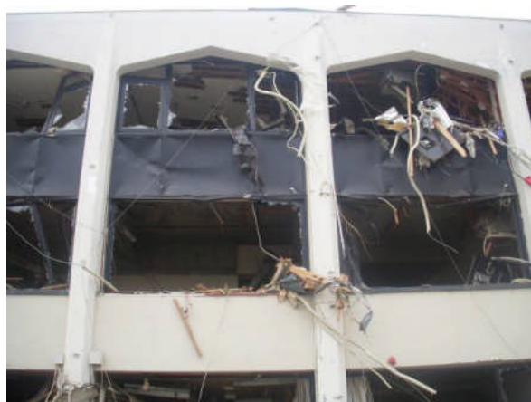
写真2 開口部と内装材の損壊
