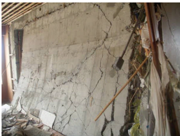
写真2 間仕切り壁の破壊
