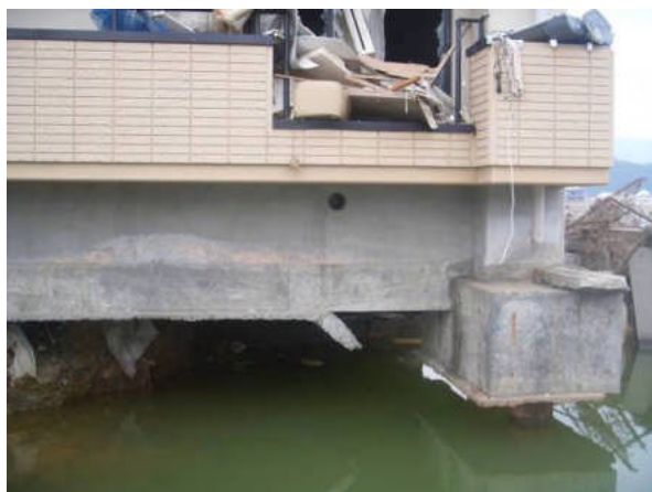
写真2 地盤の洗掘状況
