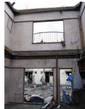
写真7 剛床ではない
