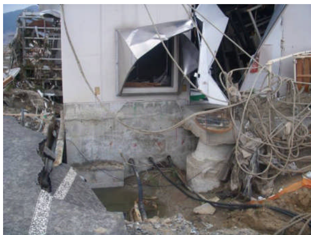
写真3 地盤の洗掘状況
