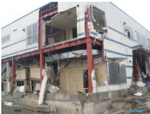
写真3 ALCパネルの脱落
