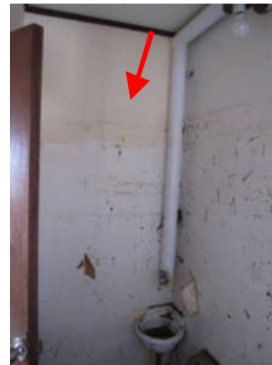
写真2 2階手洗いの浸水痕
