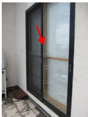
写真3 2階窓ガラスの浸水痕
