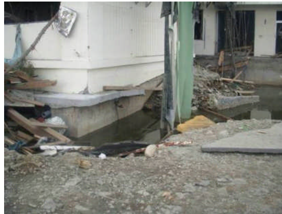
写真7 地盤の洗掘（妻面基礎部分）
