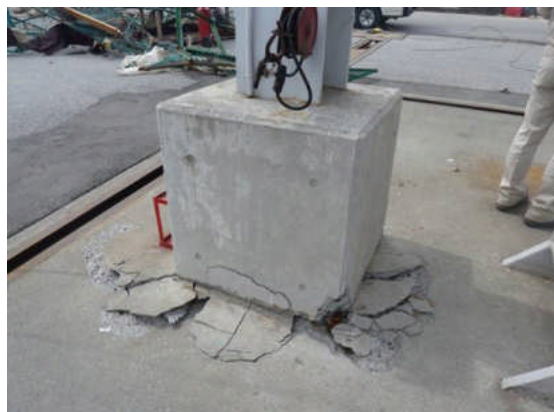
写真 3 曲げ破壊した基礎
