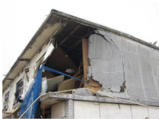
写真2 漂流物の衝突による2階部分の損傷
