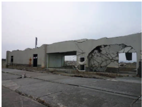
写真2 RC造建物の被害
