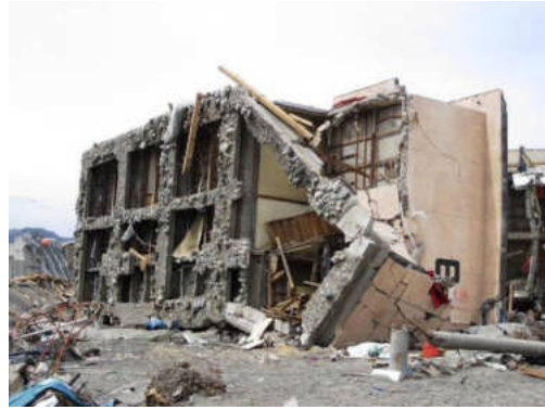
写真 9 移動し転倒した住棟 1
