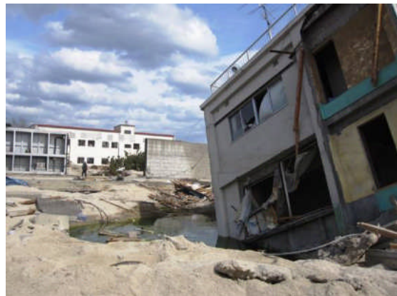
写真4 決壊した水門と建物の位置関係
