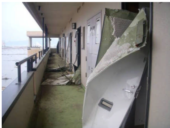
写真4 3階外廊下の被害状況
