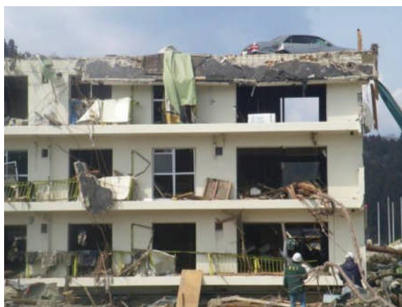
写真2 開口部の損壊と屋根に残存した乗用車
