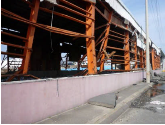
写真 5 柱の変形（倉庫 2）
