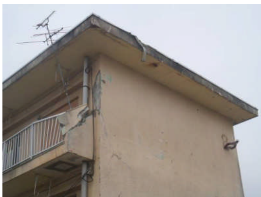
写真3 パラペットの破損
