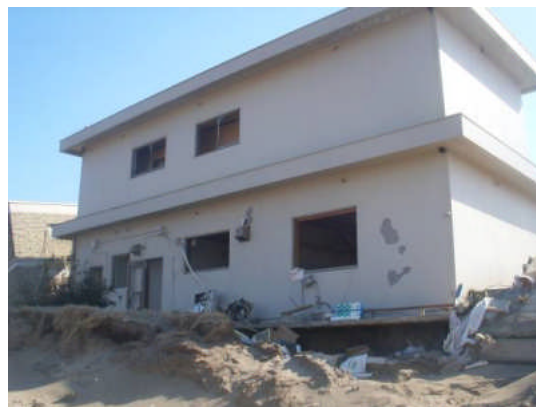
写真2 北側地盤の洗掘
