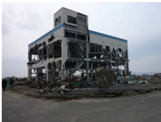
写真2 外装材の被害
