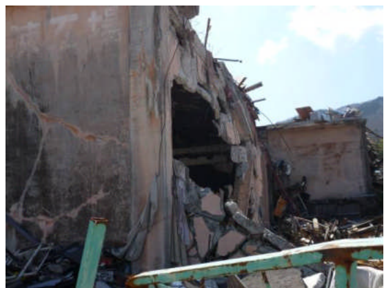
写真2 柱折損 (建物西面)
