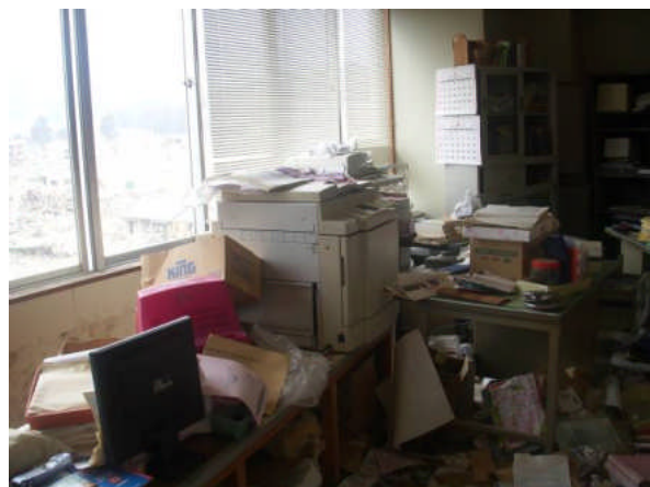
写真3 4階内部の状況 (4階の備品類等は流失していない)
