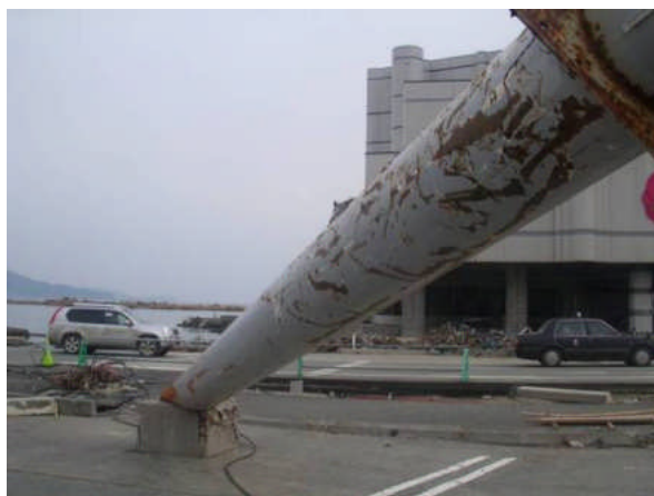
写真1 鋼製柱の折損状況
