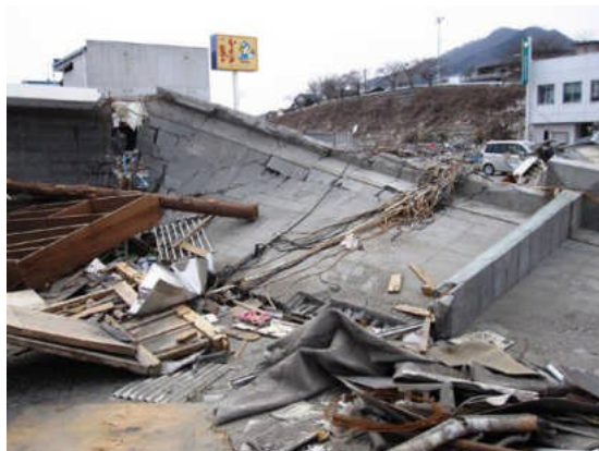
写真2 転倒したコンクリートブロック壁(1)
