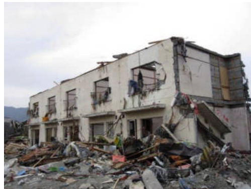
写真4 一住戸分が損壊した住棟
