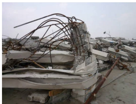
写真2 倒壊したRC造柱
