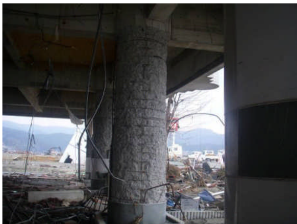
写真3 1階エントランスの被害状況
