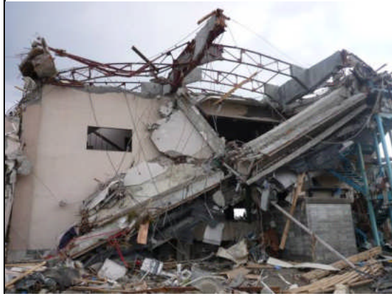
写真5 ホール側の被害状況
