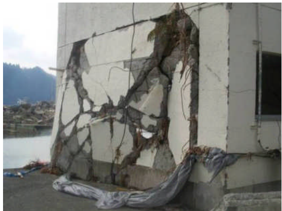
写真4 外壁の破壊状況
