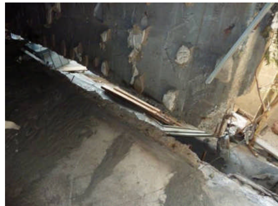
写真 4 主筋が破断した壁脚部
