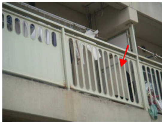
写真2 住戸間の仕切りの破損状況 (2階)
