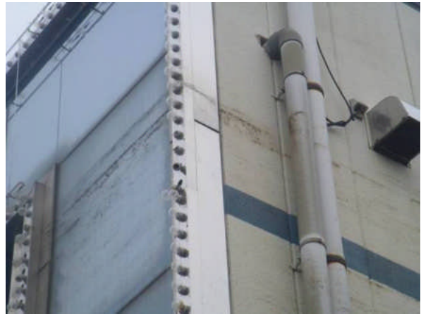
写真2 壁面に残った浸水痕
