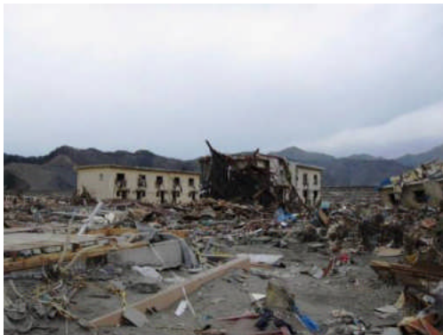
写真3 残存した住棟
