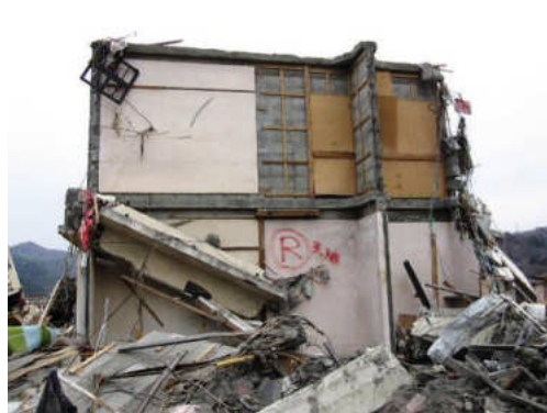
写真5 損壊した住戸の部分
