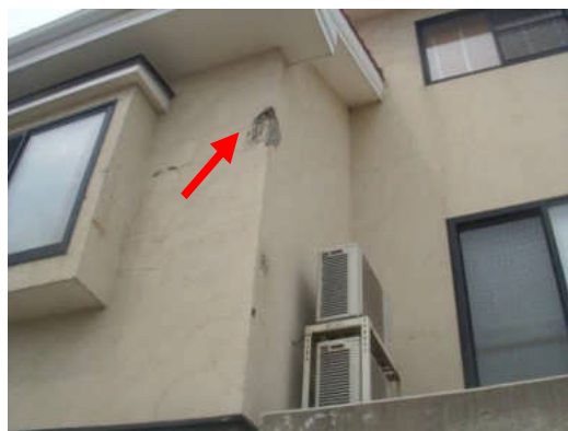
写真4 2階外壁の衝突痕
