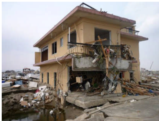
写真 2 1階妻壁の被害
