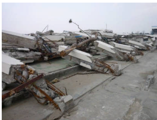
写真3 柱が同じ方向に倒壊
