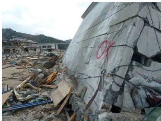
写真4 コンクリートブロック壁のはらみ出し
