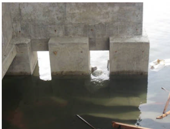
写真3 基礎周辺の洗掘の状況
