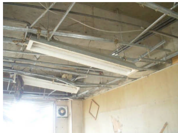
写真3 1階天井仕上げ材の被害状況
