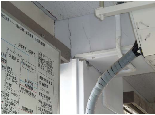
写真 B-53 梁間方向の梁端部に生じた 曲げひび割れ
