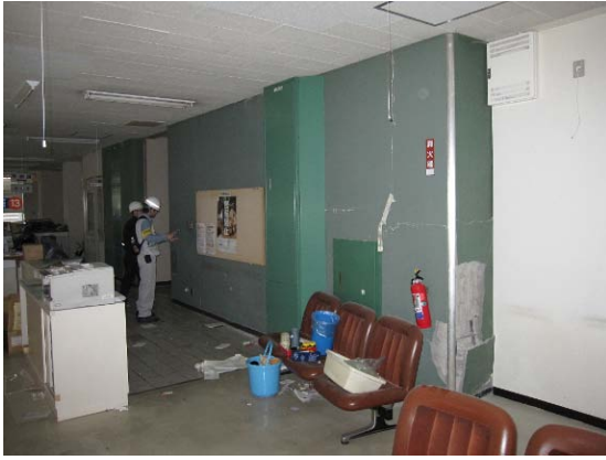
写真B-15 耐力壁側柱の主筋座屈(1階)
