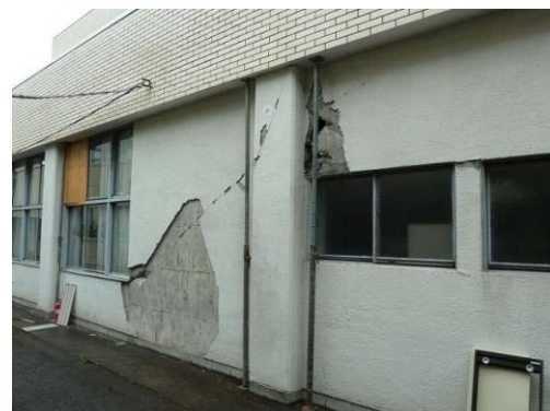
写真 B-7 片側袖壁付き柱のせん断ひび割れ (1 階、損傷度 IV)
