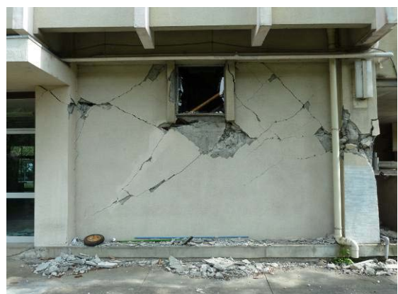
写真 B-46 開口付き耐力壁のせん断破壊 (損傷度 V : ㊦通り①-②間)
