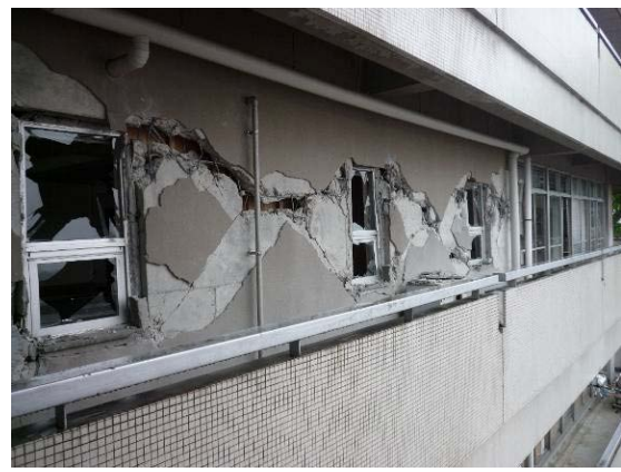
写真B-18 非構造壁のせん断破壊(2階)
