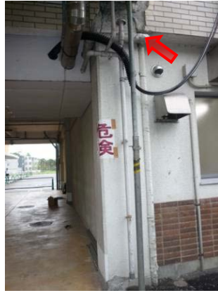
写真 B-12 柱梁接合部における損傷 (1-H)
