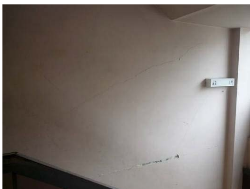
写真 B-23 耐力壁の被害 (2階梁間方向)
