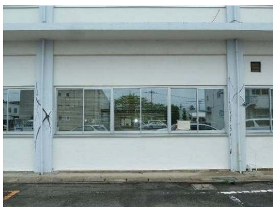
写真 B-39 柱のせん断破壊（損傷度 IV）
