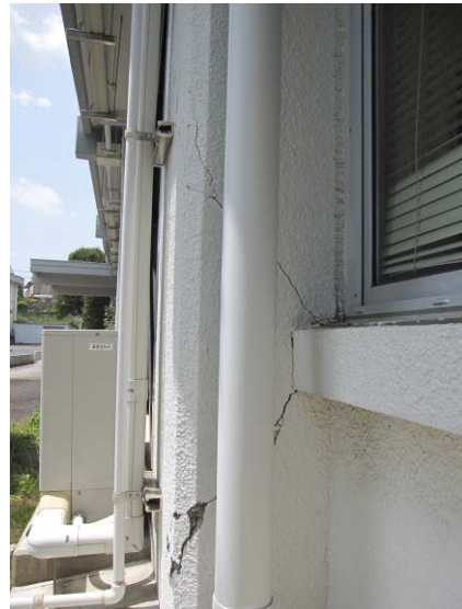
写真 B-50 補強ブレースが取り付け柱の構面外に生じたせん断破壊 (A-8柱)
