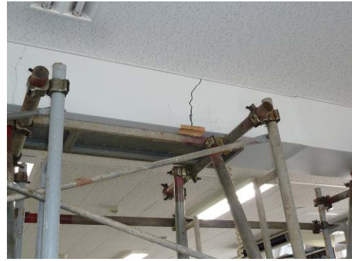
写真 B-54 梁間方向の梁中間部に生じた ひび割れ (⑨通り：ひび割れ幅 5mm)
