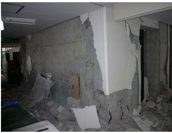
写真B-17 耐力壁のせん断破壊(2階)
