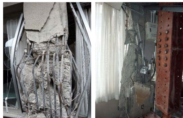
写真B-14 腰壁付き柱のせん断破壊(1階)
