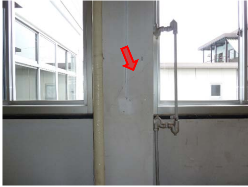
写真 B-33 腰壁、垂れ壁付き柱のせん断ひび割れ (1階、損傷度 II)
