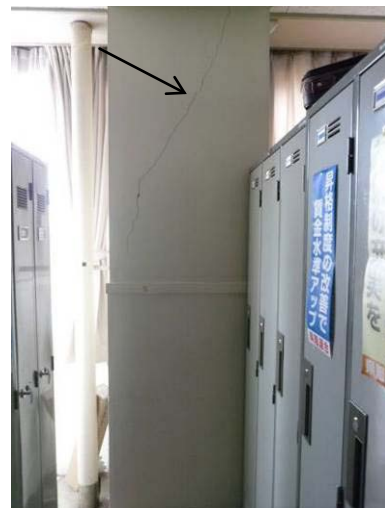
写真 B-22 柱のせん断ひび割れ (3 階、損傷度 III)
