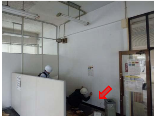
写真 B-35 袖壁のせん断ひび割れ (1階8構面)
