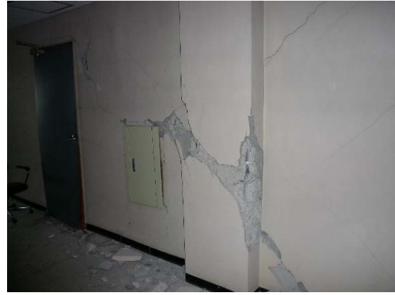
写真B-16 長柱のせん断破壊(2階)
