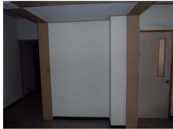
写真 B-20 非構造壁のせん断ひび割れ (1階)
