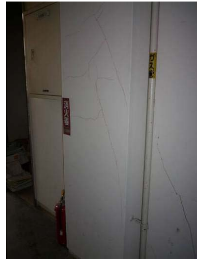
写真 B-28 柱せん断ひび割れ (損傷度 II)
