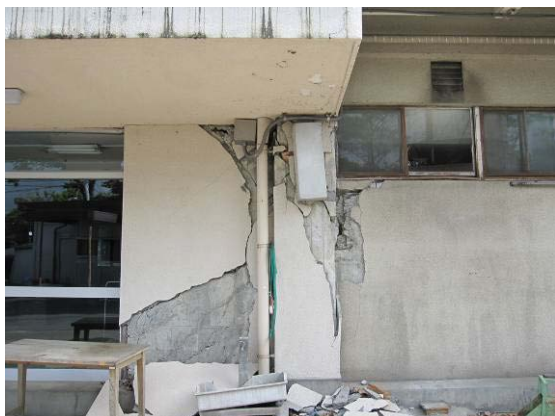
写真 B-45 袖壁付き柱のせん断破壊 (損傷度 V : ㊦通り⑦柱)
