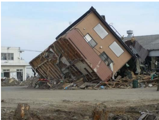
写真 6. 4. 1-14 転倒した木造建築物
