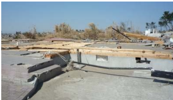
写真 6. 4. 1-16 上部構造が流失し土台が残った例
