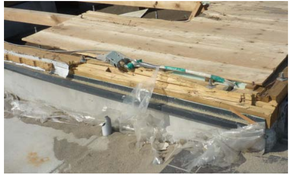
写真 6. 4. 1-19 床板も残存した例
