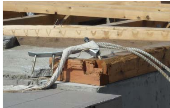
写真 6. 4. 1-21 ホールドダウン金物が破損した例
