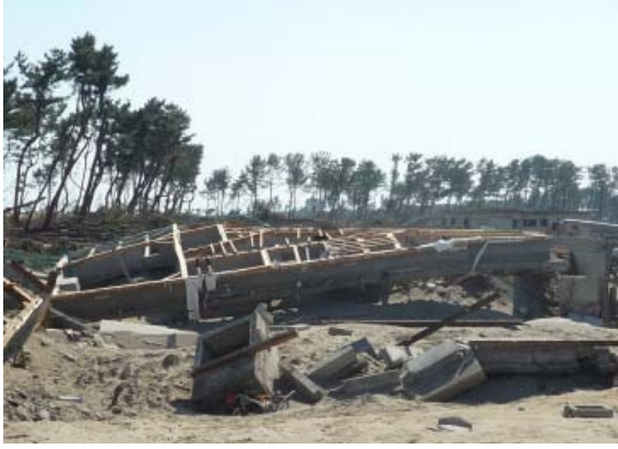
写真 6. 4. 1-18 基礎が流失した例
