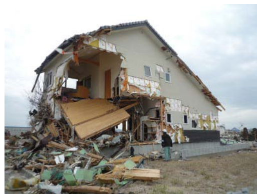
写真 6. 4. 1-9 建築物隅部を流失しつつも残存した事例(2)
