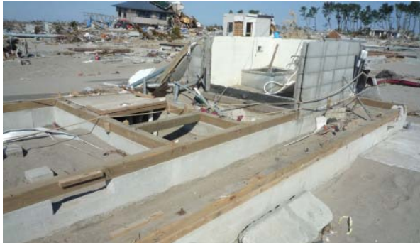
写真 6. 4. 1-20 CB 造の浴室立ち上がり部分を残して上部構造が流失した例
