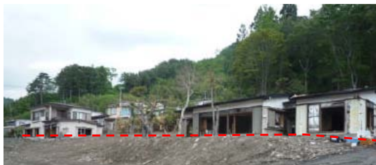
写真 6.4.2-3 写真 6.4.2-1 の住宅地の標高が写真 6.4.2-2 よりも高い場所に建つ建物。 (赤破線よりも標高が低い場所に建つ建物はほぼ流失)
