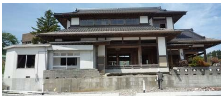
写真 6.4.2-5 浸水深6～7mの場所に建ち、流失を免れた木造住宅
