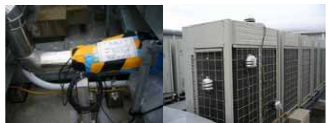
図6 個別分散型空調機の性能測定
