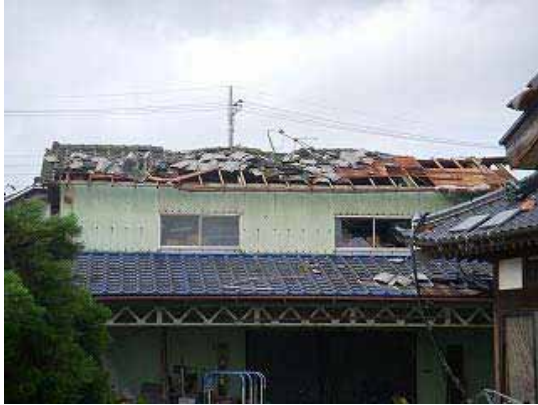
写真 1.4.1.7 建築物の被害状況(5) (土浦市の竜巻被害)
