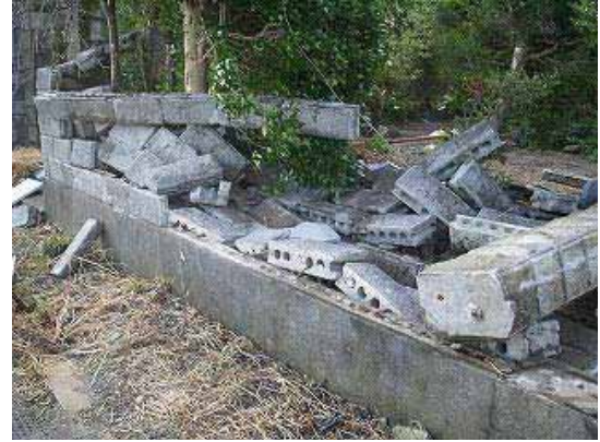
写真 1.4.1.8 ブロック塀の倒壊 (土浦市の竜巻被害)
