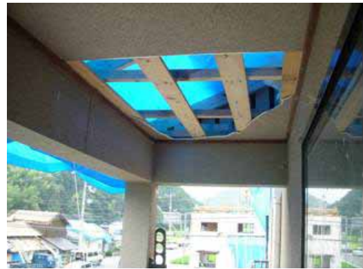
写真 1.4.1.4 建築物の被害状況(2) (美作市の竜巻被害)
