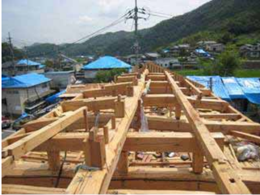
写真 1.4.1.3 建築物の被害状況(1) (美作市の竜巻被害)
