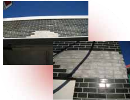
タイル直張り仕上げ外壁の剥落
