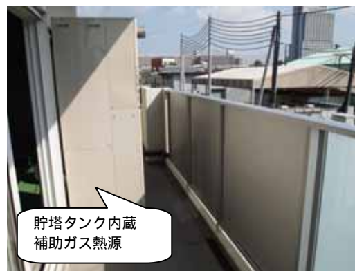
写真5 ソーラー給湯システム実用化製品設置例 (ベランダ内)
