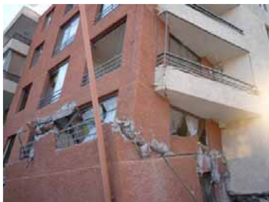
写真 - 1 壁柱が大きく破壊した集合住宅
