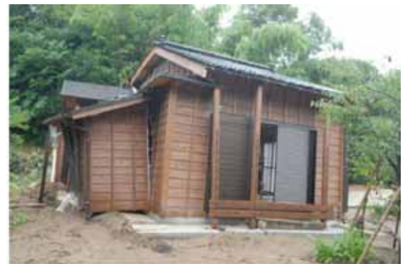
写真 1 緩傾斜地盤の過大な地盤変状 ( 地盤流動 ) により居住不可能ほどの基礎被害を受けた平野部に位置する住宅 ( 柏崎市 / 2007 年新潟県中越沖地震 )
