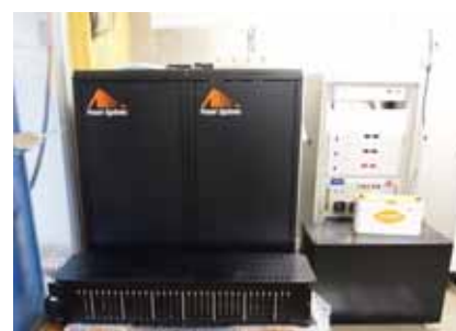
写真2 蓄電装置 左奥：キャパシタバンク (1.6kWh) 手前：リチウムイオン電池 (160AH)
