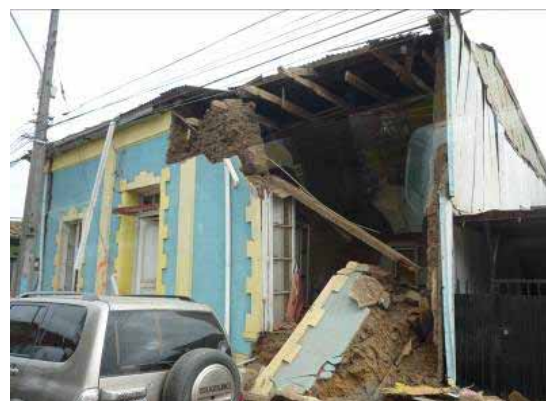
写真 - 2 アドベ造建物の被害
