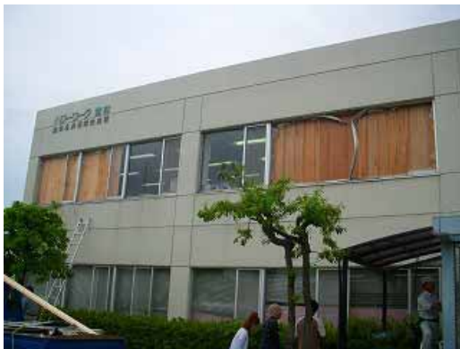
写真 1.4.1.5 建築物の被害状況(3) (館林市の竜巻被害)
