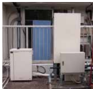
写真1 ガスエンジン発電ユニット
