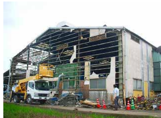
写真 1.4.1.6 建築物の被害状況(4) (館林市の竜巻被害)
