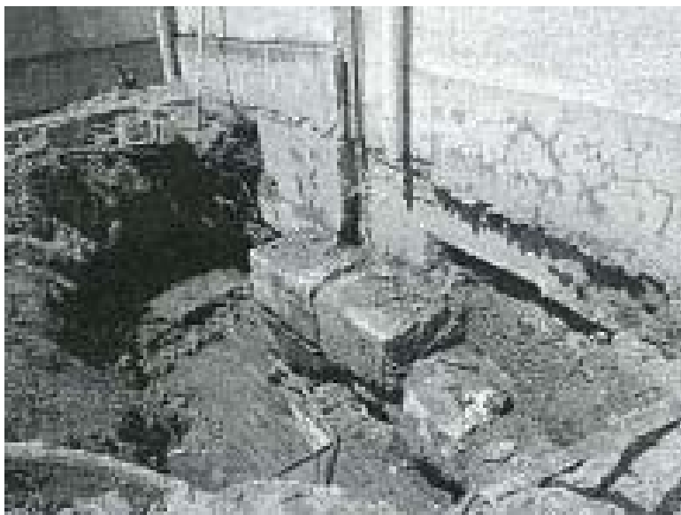
基礎フーチングの過大なひび割れ
