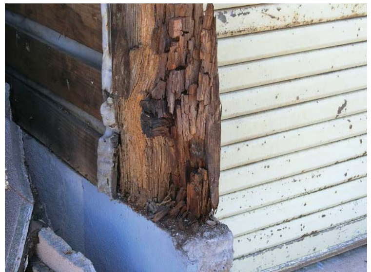
写真3 柱脚の激しい腐朽
