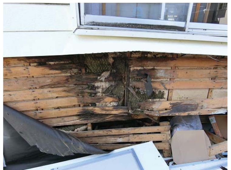
写真2 開口下部の下地板の腐朽
