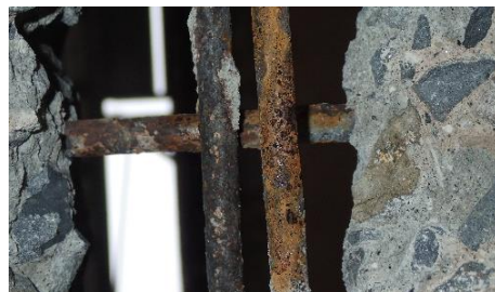
バルコニーの鉄筋腐食
