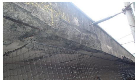
屋上庇の鉄筋露出
