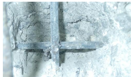
妻壁の鉄筋腐食
