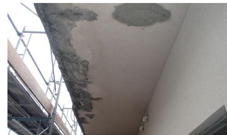
屋上庇の鉄筋露出
