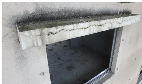
窓枠のひび割れ
