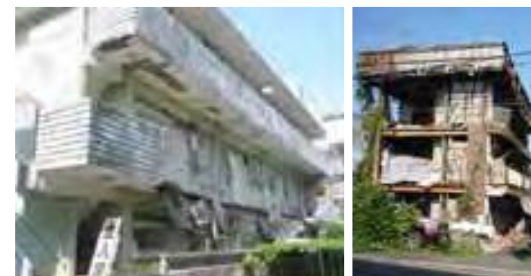
外壁の剥落等が生じた事例 (国土交通省HPより)
