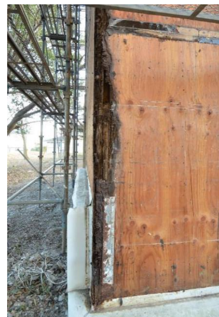
写真5.3 北東隅部躯体の腐朽・蟻害
