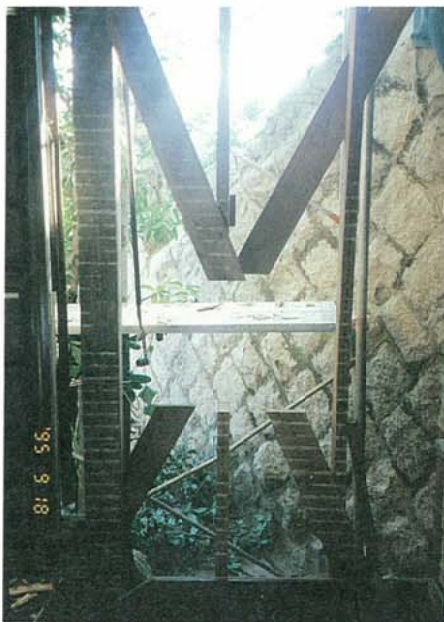
写真3.2.3.45 K氏宅 玄関ホール筋違い切断箇所
