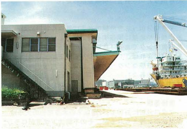
写真3.2.4.1 側方流動によるS造倉庫の被害 (足元が海側に向かって開いている。杭基礎)
