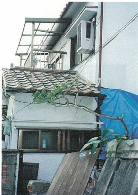
写真3.2.3.13 [復旧事例, 大石1] 被災後の状況 (1995年2月)
