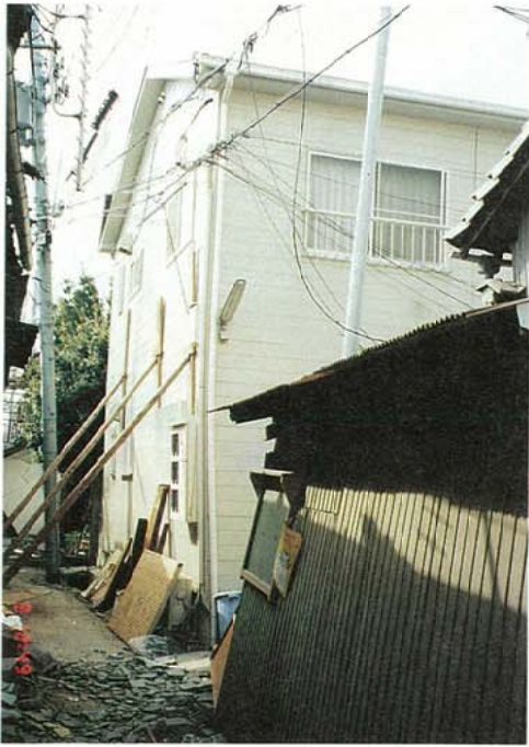
写真3.2.3. 7 [復旧事例、長田2] 被災後の状況 (被害度IV)
