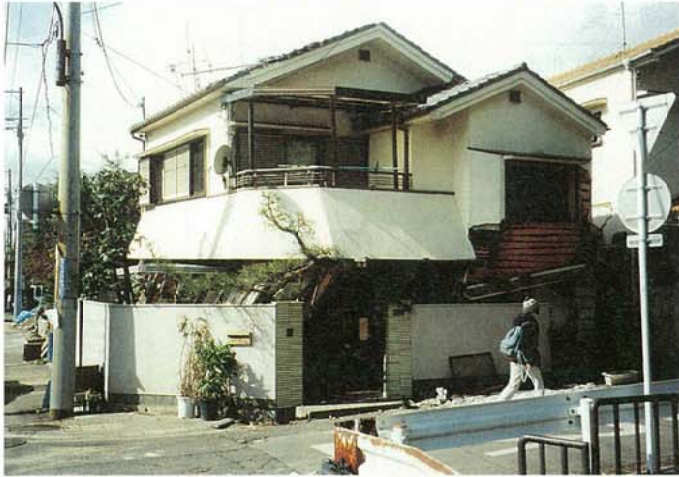
写真3.2.3.17 ブロックの被災後の状況 (東灘区本山中町3丁目9番、1995年2月)
