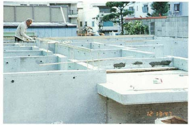
写真3.2.3.24 新築基礎例（隅角部にホールダウン用の長いアンカーボルト）
