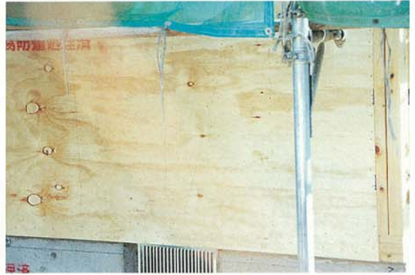
写真3.2.3.30 新築建物の筋かい（合板の上から筋かいに釘打ち） ↓筋かい位置
