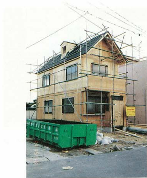
写真3.2.3.32 新築建物の耐力壁（枠組壁工法住宅の外壁長さの問題例）
