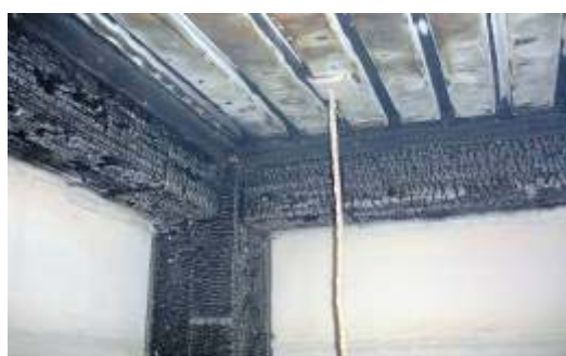
図26 実験後の火災室内部
