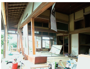
写真2 写真1の内部、柱の折損
