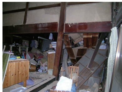
写真4 写真3の内部、柱の折損
