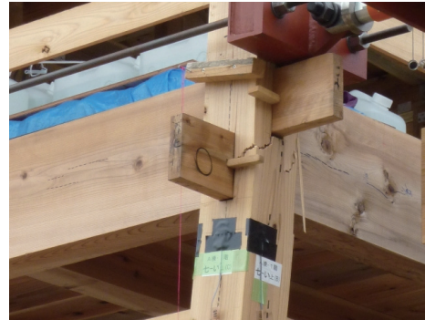
写真9 静的加力実験による柱の折損
