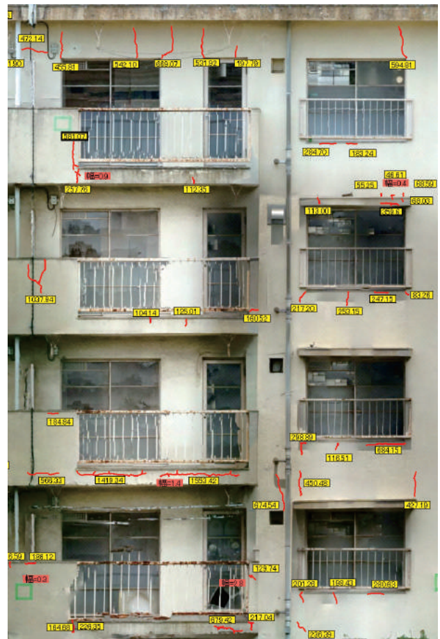
図10 南面外壁のひび割れ図（オルソ画像）
