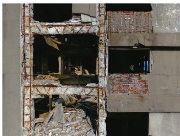
写真6 構造躯体欠損の状況(端島30号棟)
