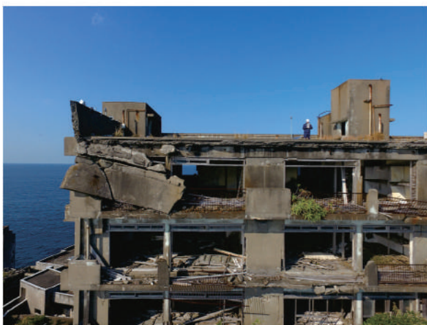
写真9 外壁・パラペット破損の状況（端島3号棟）
