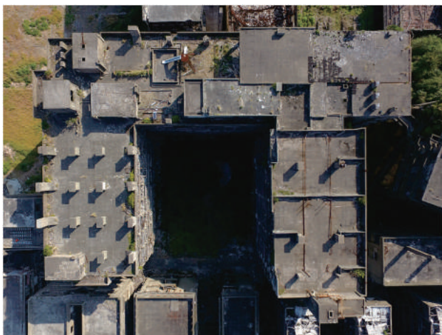
写真7 屋上の構成と損傷状況（端島65号棟）
