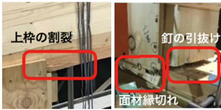
(a) 上枠の割裂 (b) 脚部の引き抜け
