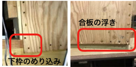
(c) 脚部のめり込み (d) 合板の浮き
