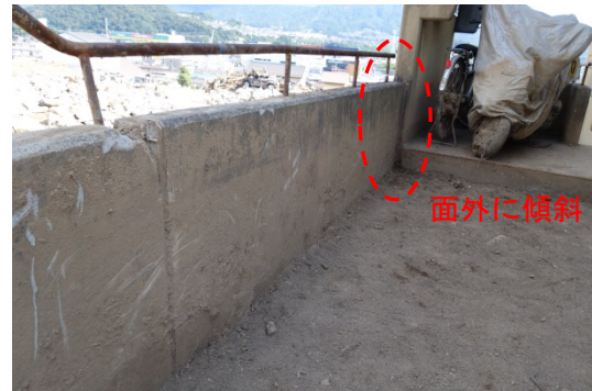
写真 22 8号棟擁壁の面外への傾斜
