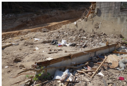
写真 25 上屋が流失した木造家屋の基礎
