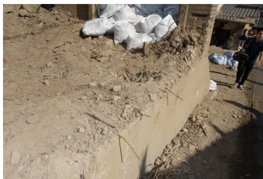
写真 27 流失したとみられる壁の痕跡
