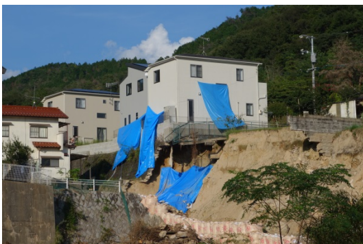
写真 34 基礎地盤の一部が抉られた住宅 (写真 30 の右手方向)
