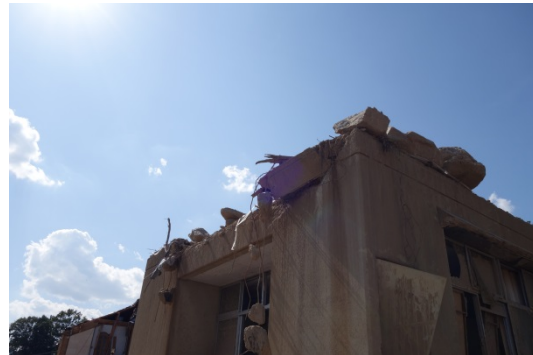
写真 14 パラペットの被害状況
