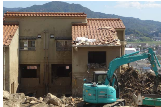
写真6 5号棟西側住戸瓦の損傷
