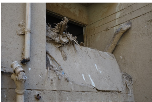
写真9 5号棟山側腰壁の面外変形
