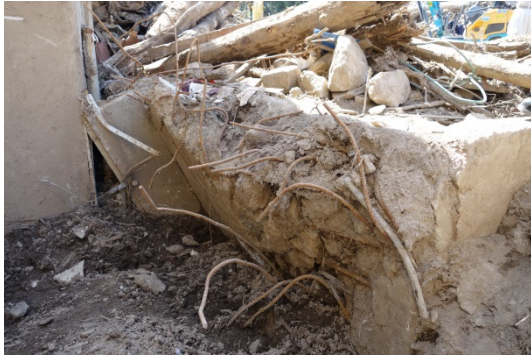
写真 11 5号棟山側 RC 造壁の被害
