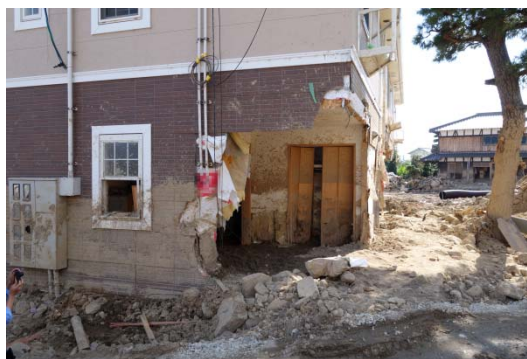
写真 29 付近の木造アパートの被害
