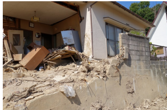
写真 24 ブロック壁の被害
