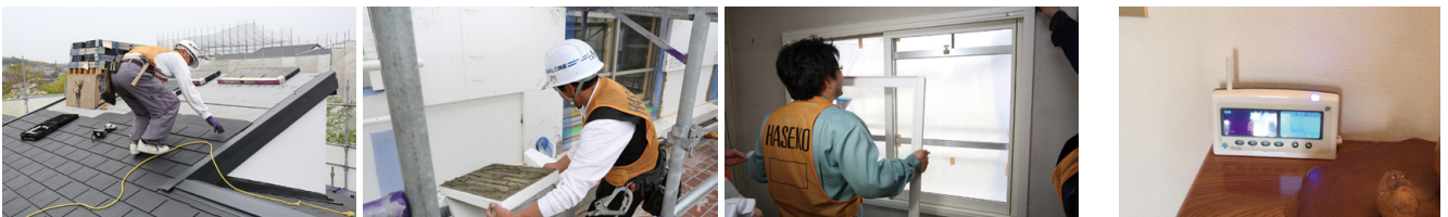
屋根、外壁の外断熱の改修工事および二重窓の取り付け工事の様子
