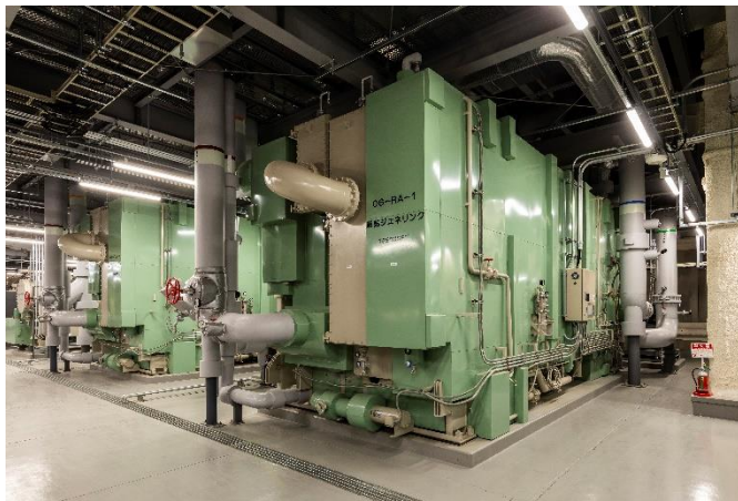
廃熱投入型蒸気吸収冷凍機
