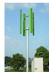
小型風力発電設備
